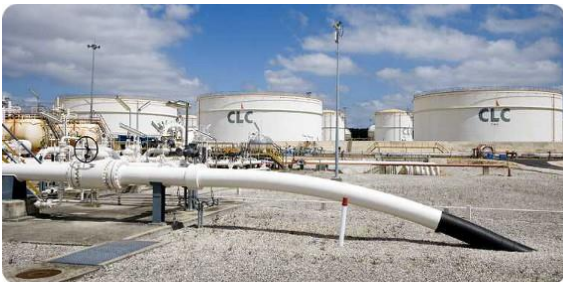
Figura 3: Ponto de chegada do oleoduto multiproduto à CLC. (CLC, 2016)
