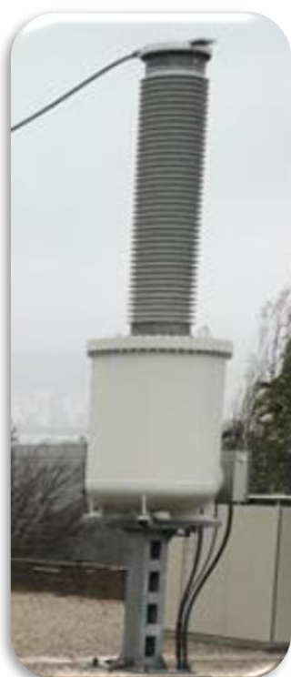
Figura 17 – Transformador de Tensão de Alta Potência
