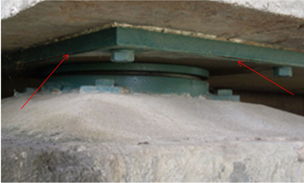
Figura 54. Anomalia em AA metálico: Degradação das superfícies de contacto (descolamento do revestimento da chapa superior)
