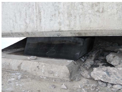
Figura 57. Deslocamento sobre a base de assentamento com elevada distorção do neoprene
