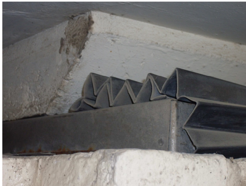
Figura 60. Aparelho de apoio elastomérico com danos resultado de actos de vandalismo
