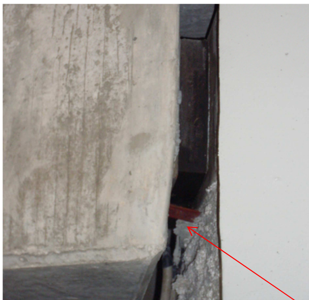
Figura 56. Permanência de chapas de travamento provisórias (a vermelho) e existência de detritos
