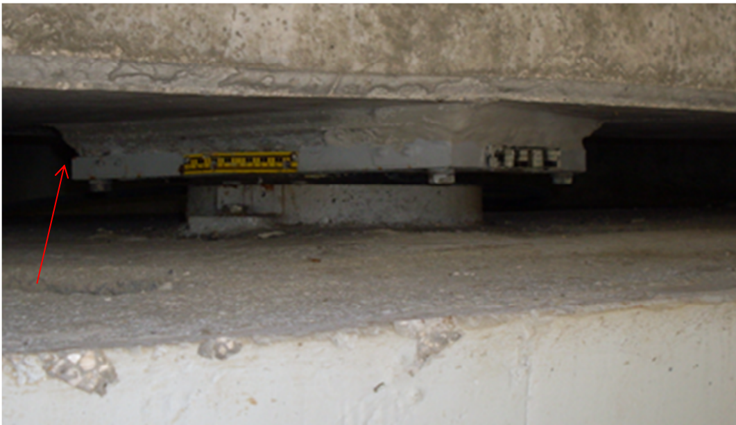
Figura 58. Anomalias nos materiais (corrosão dos elementos de aço e desgaste do betão) e deficiente planeza da superfície de apoio do AA
