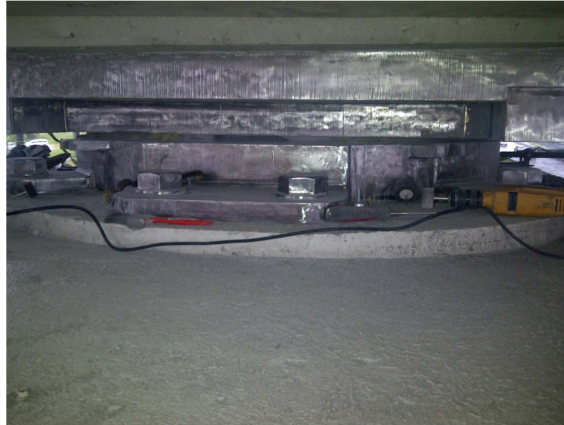
Figura 72. Aparelho de apoio após trabalhos de decapegem
