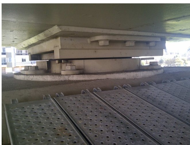
Figura 69. Aparelho de Apoio antes da sua reparação
