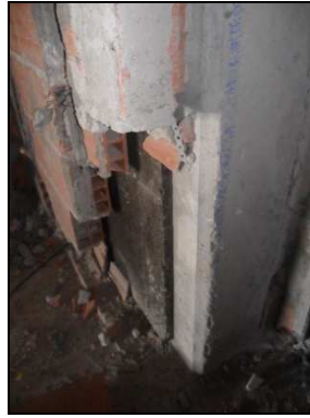
Figura 4. 13 - Parede em contacto com a caixa de elevador
