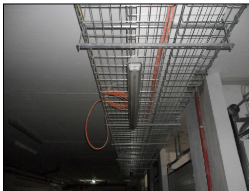
Figura 3. 56 - Luminárias nos caminhos de cabos das caves
