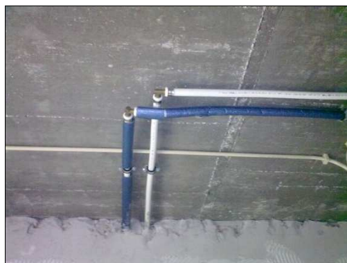
Figura 3. 10 - Cruzamento da tubagem de água quente e fria
