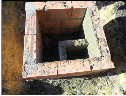
Figura 3. 15 - Caixa de reunião em alvenaria
