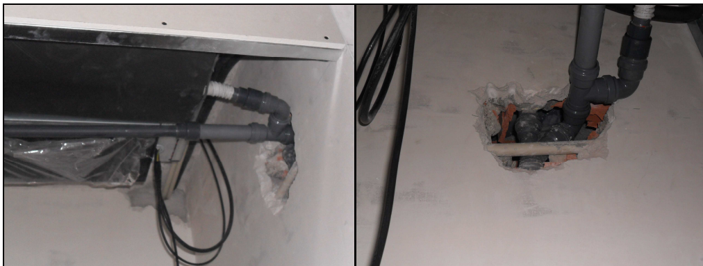
Figura 3. 42 - Drenagem dos condensados das máquinas
