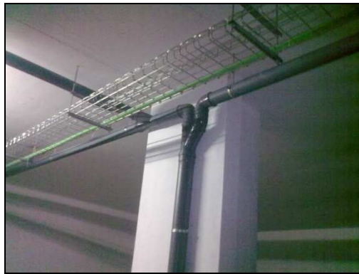
Figura 3. 52 – Caminho de cabos
