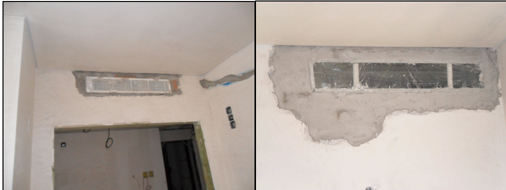
Figura 3. 41 - Grelhas de ar condicionado
