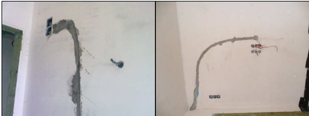
Figura 3. 60 - Roços nas paredes estucadas
