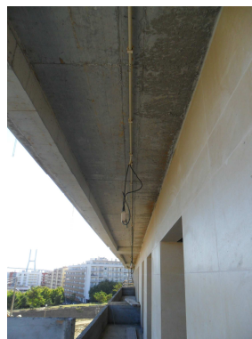
Figura 3. 62 - Instalações eléctricas nas varandas
