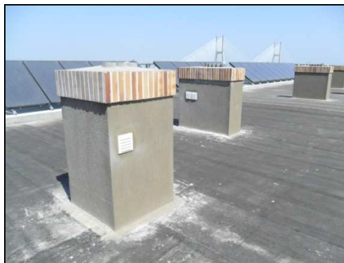
Figura 3. 28 - Chaminés de ventilação
