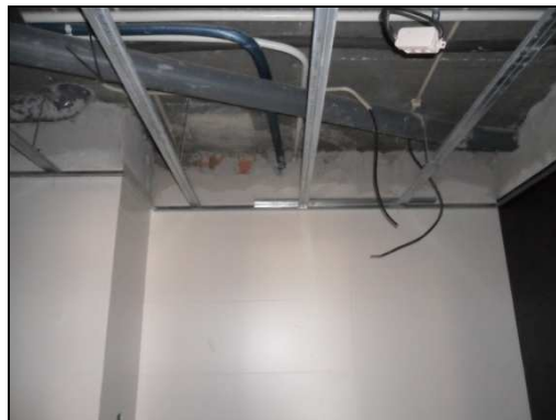
Figura 3. 5 - Tubagem embutida na estrutura do tecto falso
