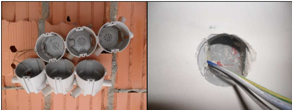
Figura 3. 51 - Caixas de applique
