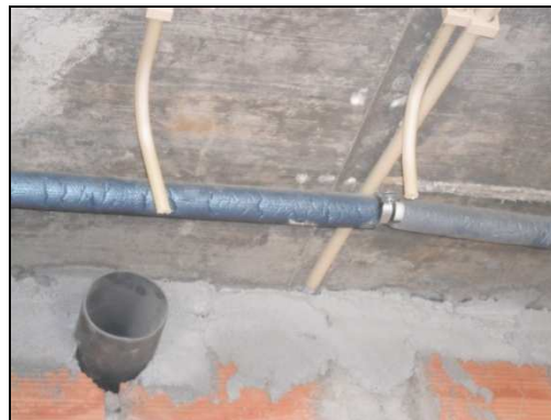
Figura 3. 61 - Cruzamento de instalação eléctrica e tubagem de água quente
