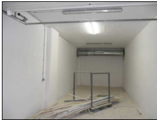
Figura 3. 57 – Canalizações nas garagens
