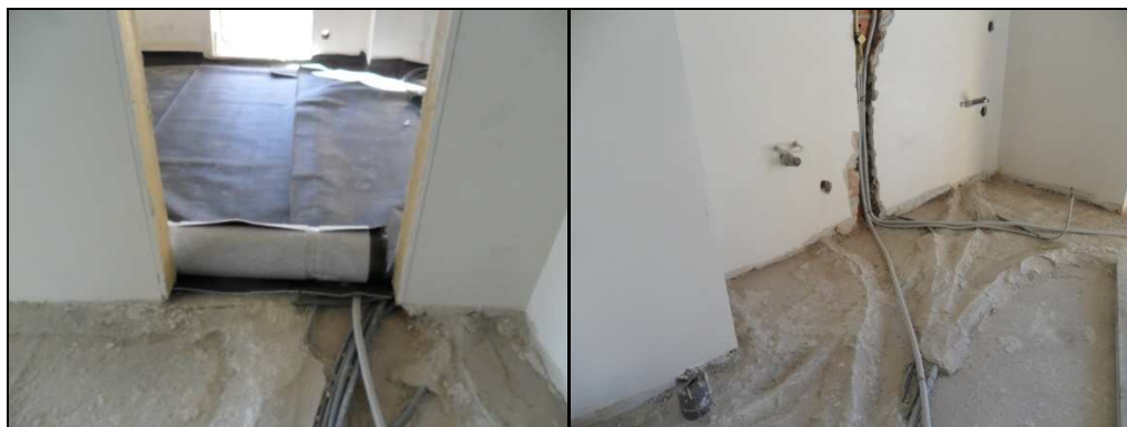
Figura 3. 64 - Tubagem no pavimento
