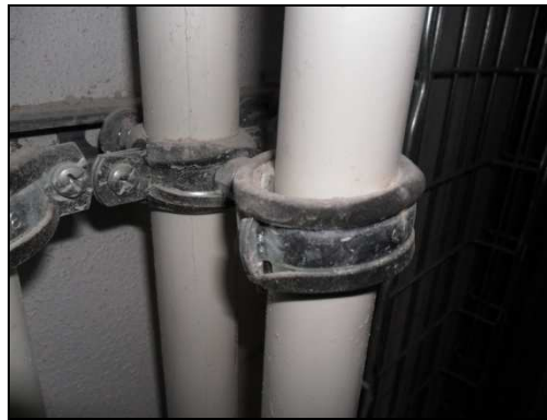
Figura 3. 6 - Material isolante acústico na braçadeira de fixação
