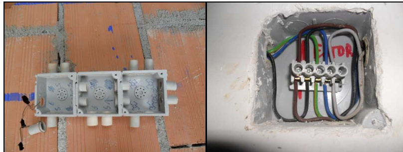
Figura 3. 48 - Caixas de derivação
