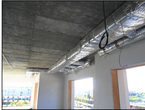
Figura 3. 39 - Condutas na sala
