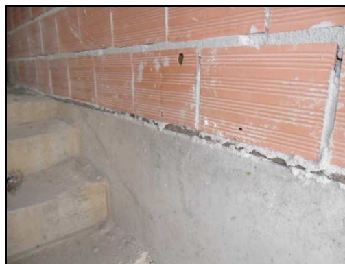
Figura 4. 14 - Separação entre alvenaria e elemento de betão armado
