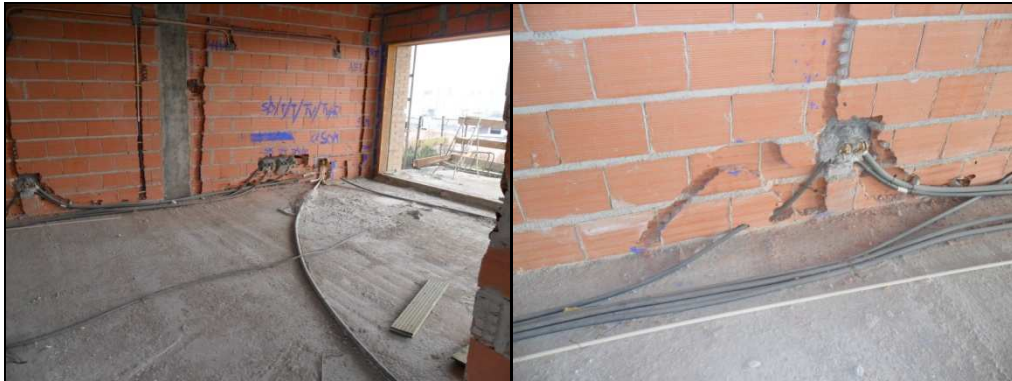
Figura 3. 55 - Roços nas paredes.
