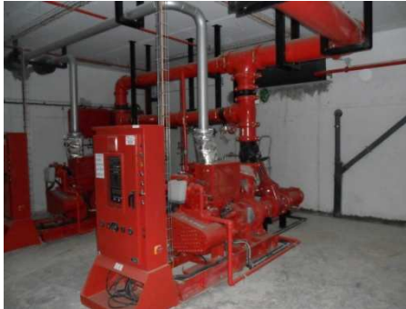
Figura 3. 66 – Equipamento de combate a incêndio
