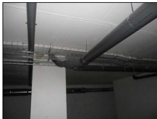
Figura 3. 33 - Cruzamento entre tubo de esgoto e prateleira metálica
