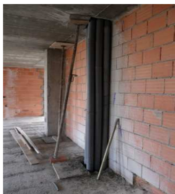
Figura 3. 25 - Tubos de queda
