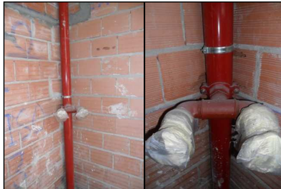
Figura 3. 68 - Bocas-de-incêndio nos patamares das escadas
