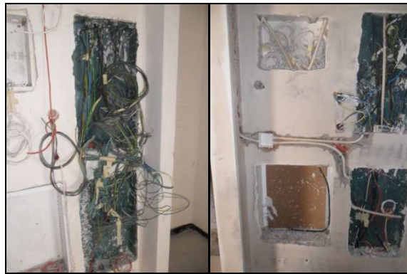
Figura 3. 63 - Fios nos quadros de distribuição
