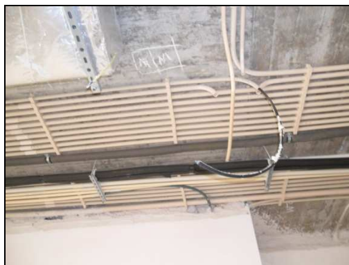
Figura 3. 54 - Condutas fixadas ao tecto
