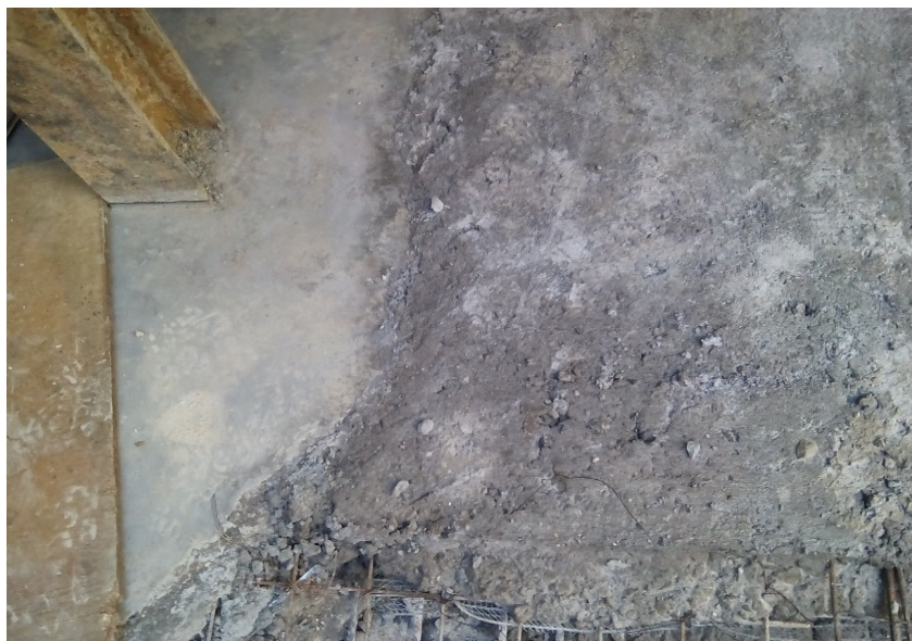
Figura 3.46 – Deficiente acabamento de laje.
