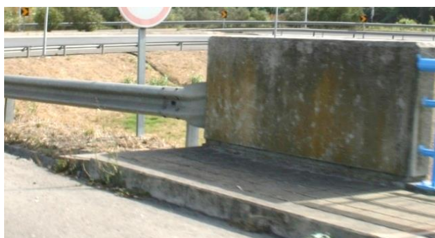
Figura 4.21 – Ligação inexistente entre o dispositivo e o muro de contenção
