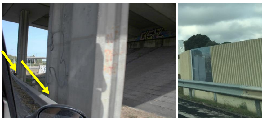
Figura 4.17 – Proteção de obstáculos com largura útil insuficiente
