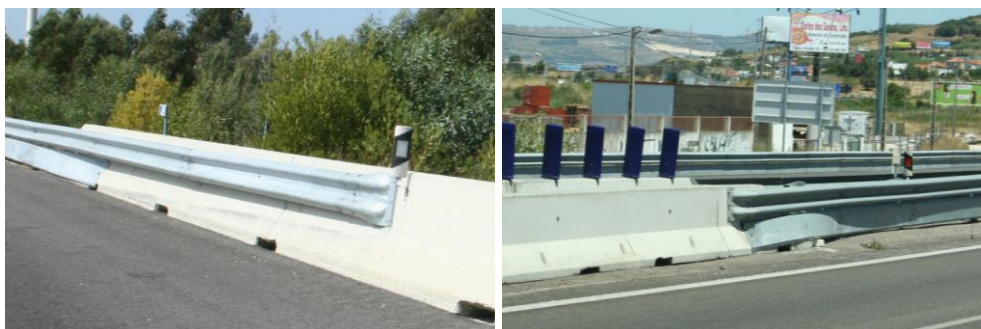
Figura 4.20 – Falta de critério nas transições entre guardas semi-flexíveis e rígidas
