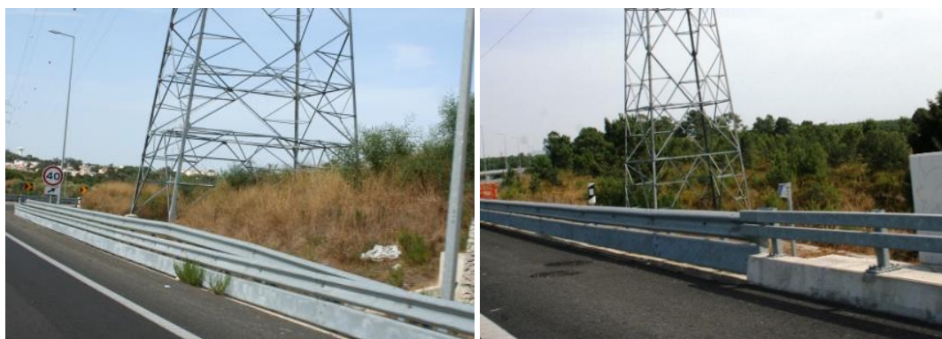
Figura 4.26 – Falta de uniformidade na proteção de obstáculos
