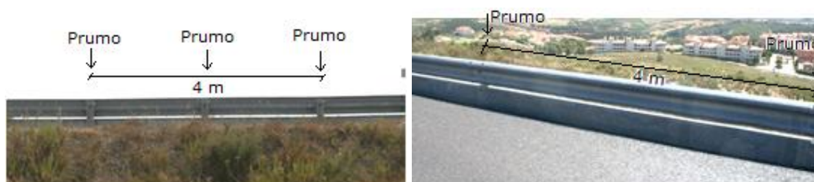
Figura 4.18 – Falta de critério no afastamento entre prumos perante talude íngreme
