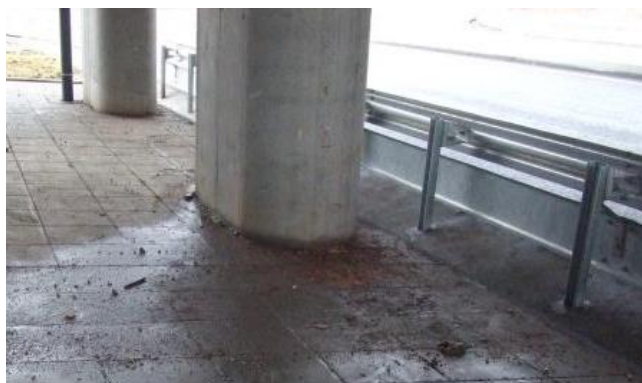
Figura 1.2 – Largura útil insuficiente junto a pilar de uma PS
