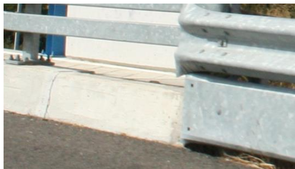
Figura 5.45 – Inexistência de biselamento no passeio do início da obra-de-arte
