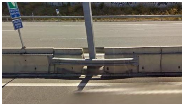
Figura 5.19 – Obstáculo mal protegido no separador central, Google Maps (street view 2009)
