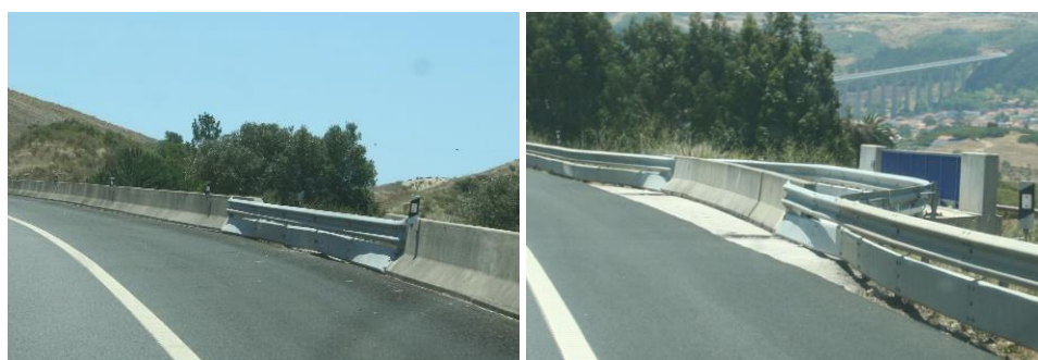
Figura 4.22 – Descontinuidade do tipo de guarda de segurança
