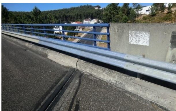
Figura 4.24 – Desajuste do nível de contenção face ao perigo em viaduto
