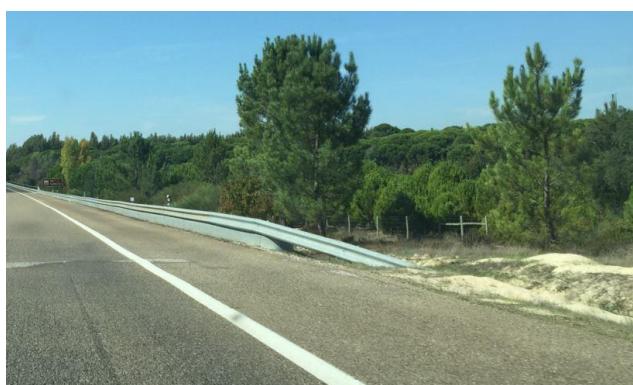
Figura 4.28 – Perigo de invasão da AAFR por detrás da guarda de segurança
