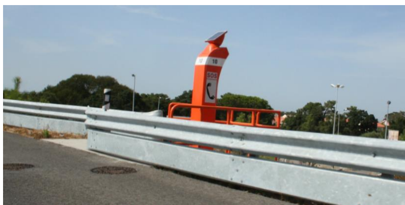
Figura 4.14 - Exemplo de posto S.O.S. localizado no limite da berma direita
