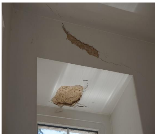
Figura 22 – Fissura no revestimento de estuque
