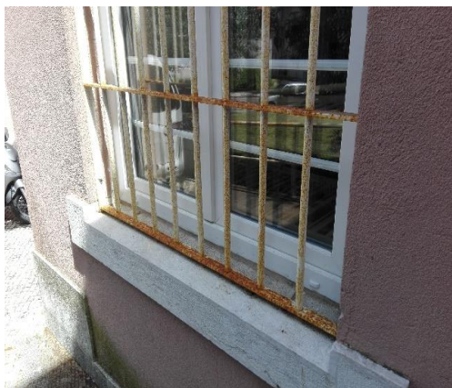
Figura 78 – Oxidação do gradeamento da janela do rés-do-chão
