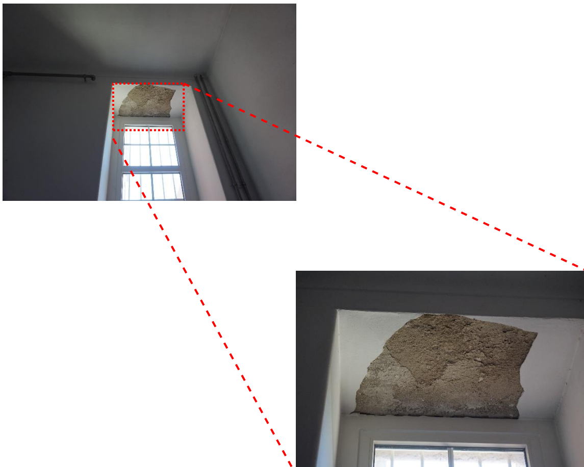
Figura 27 – Destacamento do revestimento de estuque numa instalação sanitária
