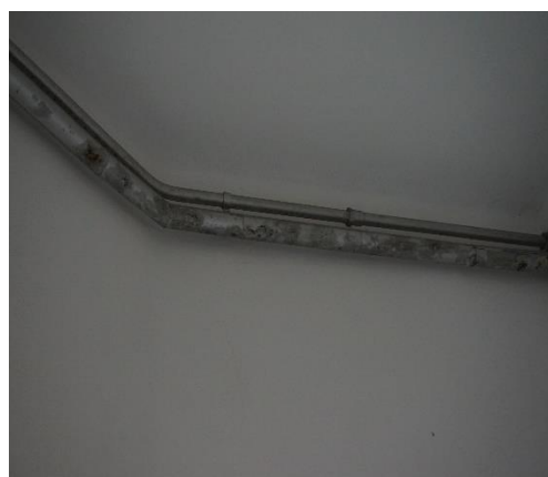
Figura 58 - Oxidação das Redes de abastecimento de água
