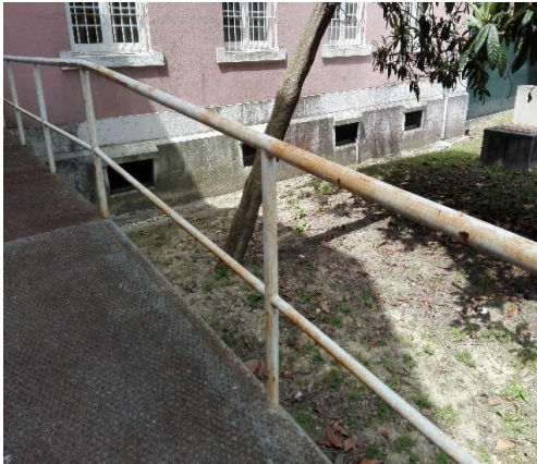
Figura 81 – Oxidação do corrimão
