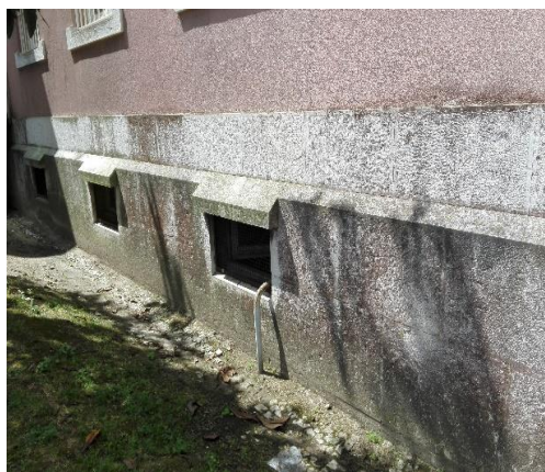
Figura 84 – Colonização biológica, manchas negras e sujidade na pedra de Lioz
