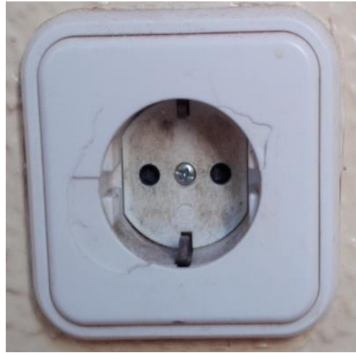
Figura 76 - Sinais de colisão no espelho da tomada elétrica [Autor, 2016]
