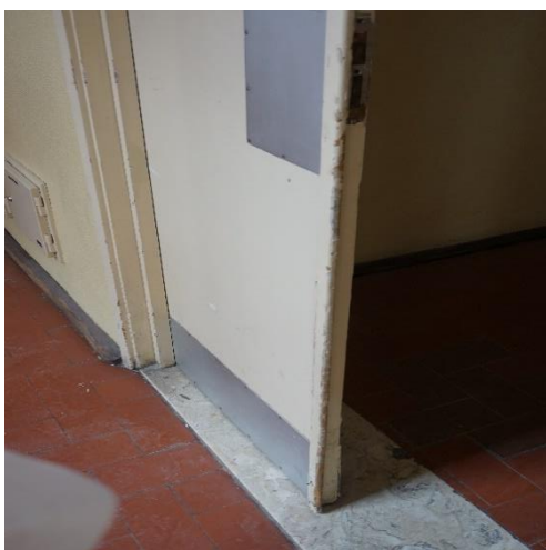
Figura 68 – Deterioração da porta de madeira
