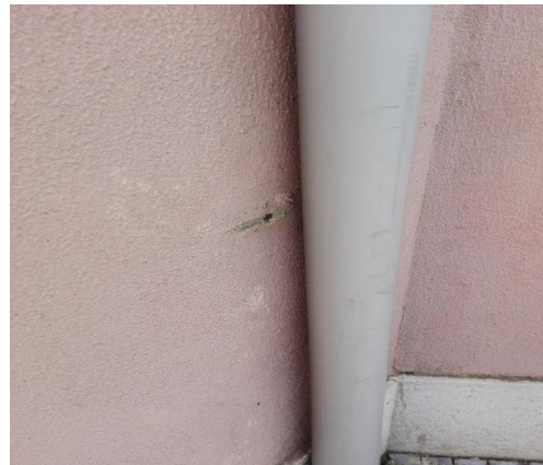
Figura 94 – Sinais de colisão do tubo de queda
