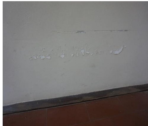
Figura 51 – Descasque da pintura na parede [Autor, 2016]
