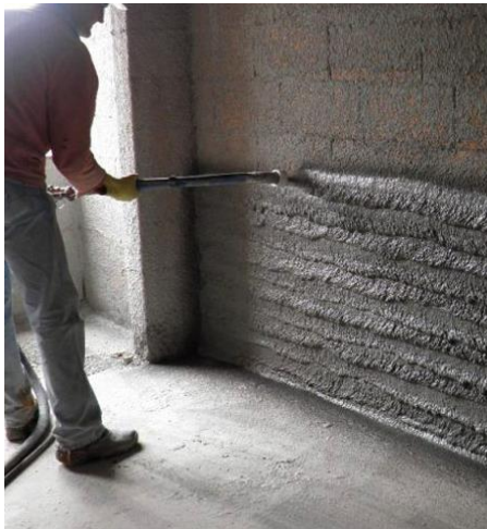
Figura 98 – Aplicação do salpico e reboco projetado [Serraglio – Aplicação de Salpico e Reboco Projetado, 2013]
