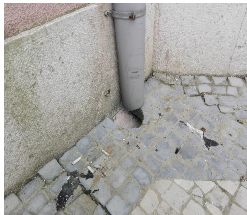
Figura 92 – Posicionamento deficiente do tubo de queda
