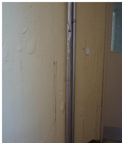
Figura 61 – Deformação das redes de abastecimento de água quente
