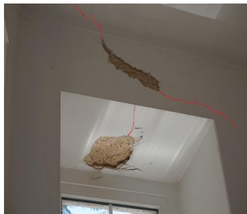
Figura 23 – Fissura no revestimento de estuque
