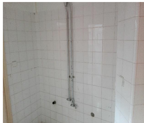
Figura 12 – Instalação sanitário do Edifício 21B
