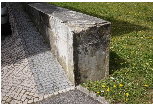
Figura 89 – Colonização biológica, manchas negras, destacamento e sujidade na pedra de calcário
