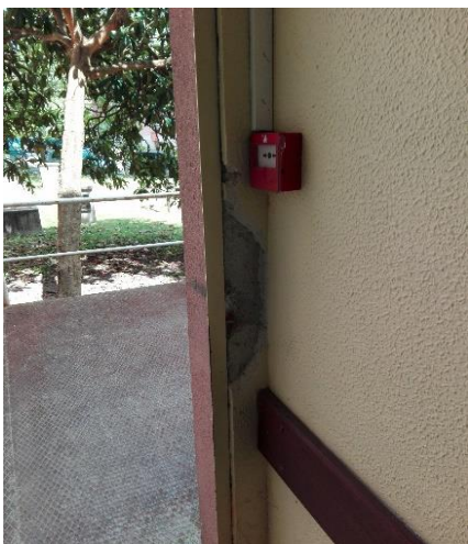
Figura 29 – Destacamento do Reboco na periferia da porta
