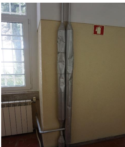
Figura 60 – Deformação das redes de abastecimento de água quente
