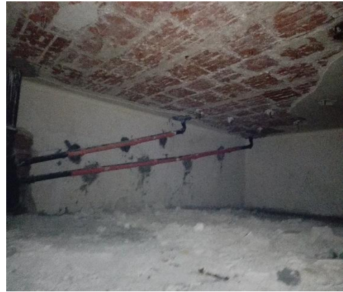
Figura 43 – Destacamento do Revestimento da Laje aligeirada
