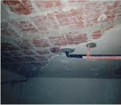
Figura 42 – Destacamento do Revestimento da Laje aligeirada
