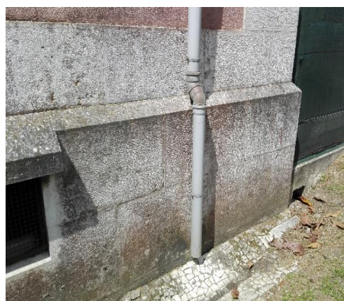
Figura 85 – Colonização biológica, manchas negras e sujidade na pedra de Lioz
