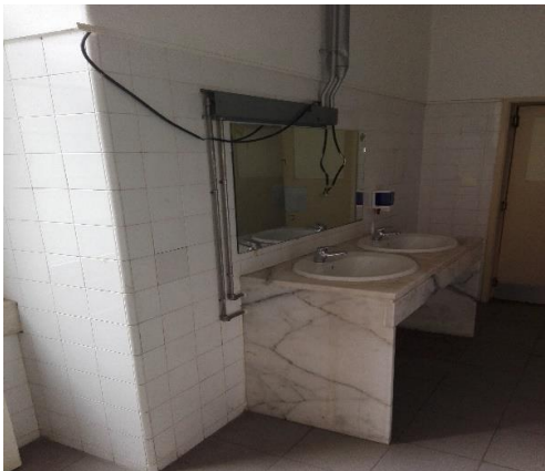
Figura 11 – Instalação sanitário do Edifício 21B
