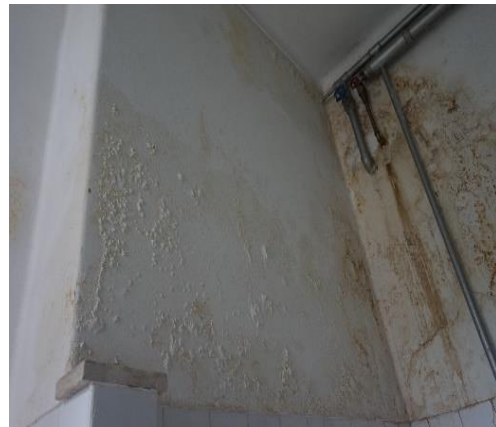
Figura 38 – Eflorescências e Criptoflorescências na parede [Autor, 2016]
