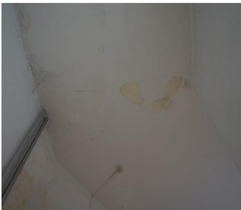
Figura 52 – Descasque da pintura no teto [Autor, 2016]
