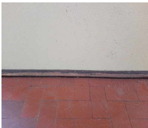
Figura 70 – Envelhecimento dos rodapés em madeira
