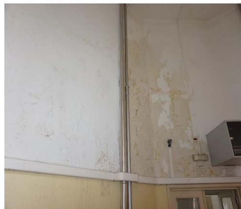
Figura 40 – Manchas de humidade na parede [Autor, 2016]
