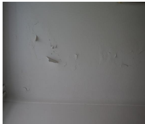
Figura 53 – Descasque da pintura no teto [Autor, 2016]
