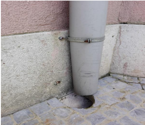
Figura 93 – Sinais de colisão do tubo de queda
