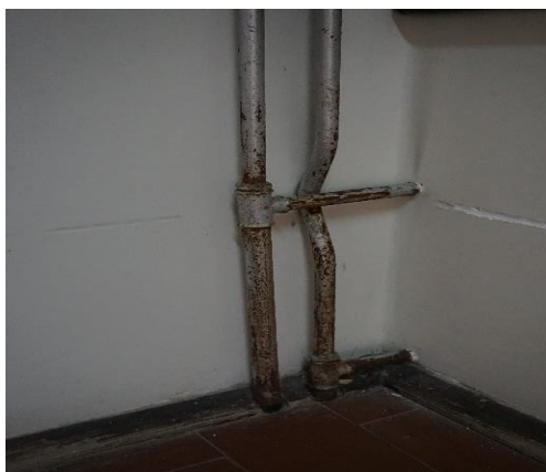
Figura 55 – Oxidação das Redes de abastecimento de água
