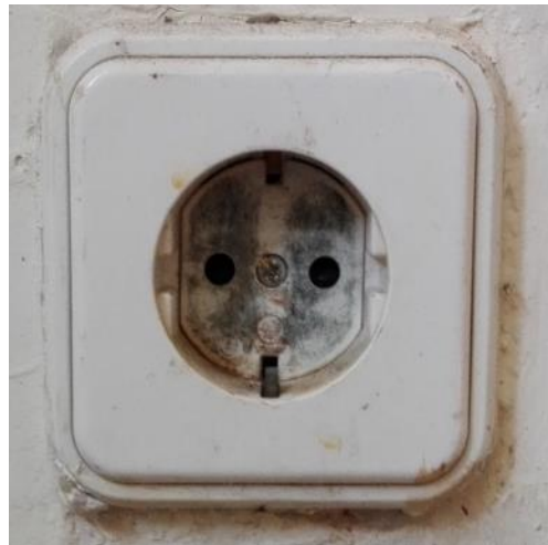
Figura 74 – Curto circuito da tomada elétrica
