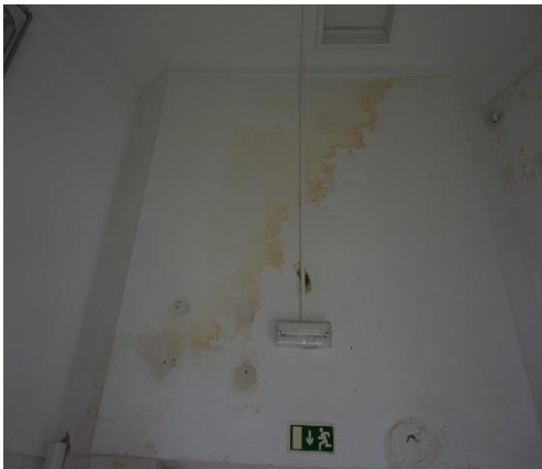
Figura 37 – Manchas de humidade na parede [Autor, 2016]
