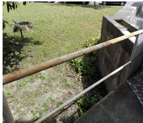
Figura 82 - Oxidação do corrimão
