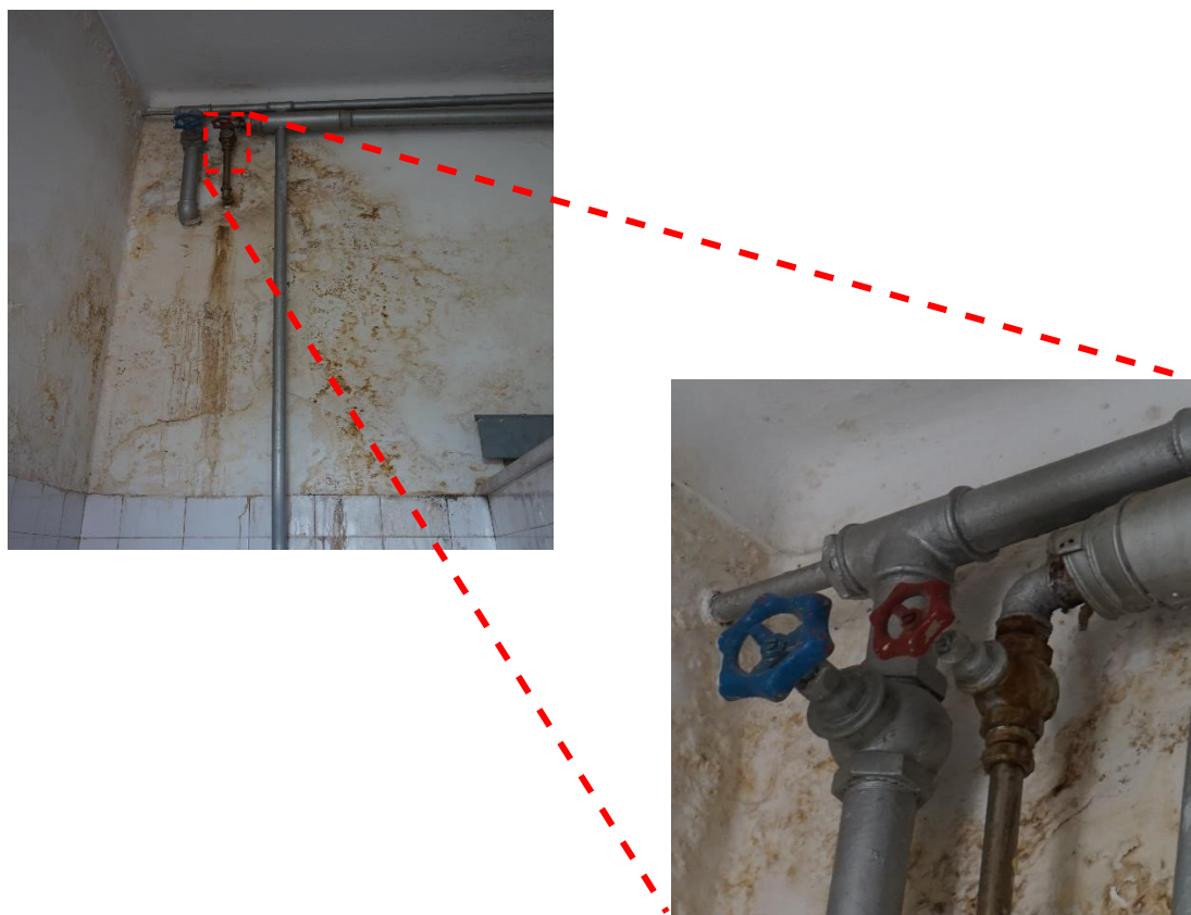
Figura 63 – Fuga de água e oxidação da tubagem
