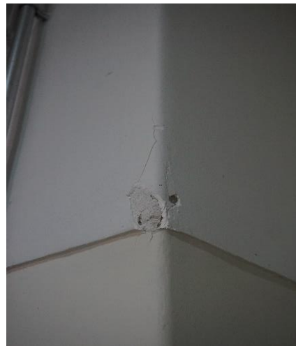
Figura 32 – Destacamento do revestimento na empena da parede
