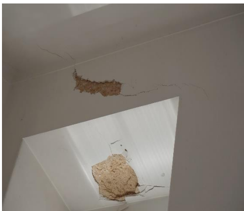
Figura 24 – Fissura no revestimento de estuque
