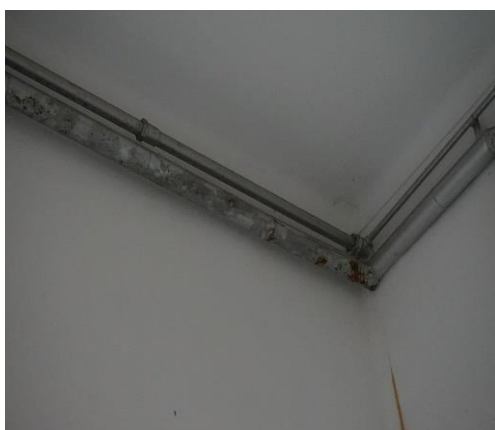
Figura 57 - Oxidação das Redes de abastecimento de água
