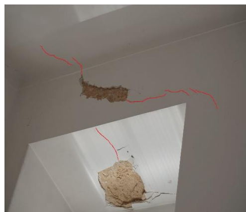
Figura 25 – Fissura no revestimento de estuque
