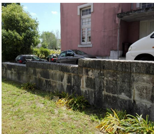
Figura 87 – Colonização biológica, manchas negras e sujidade na pedra de calcário
