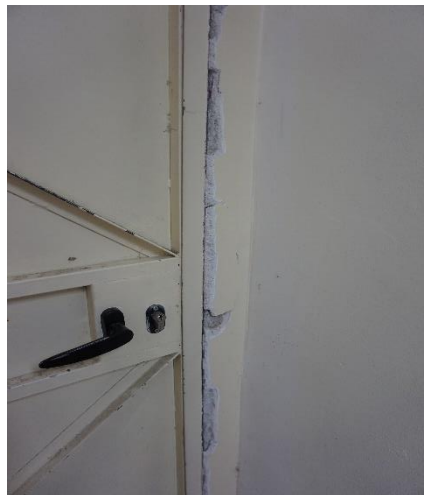
Figura 30 – Destacamento do Reboco na periferia da porta
