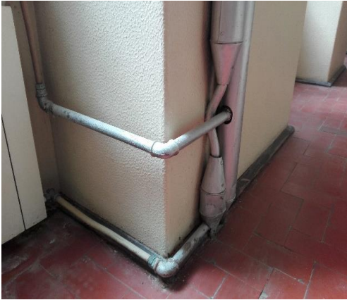
Figura 17 – Redes de abastecimento de água em aço galvanizado
