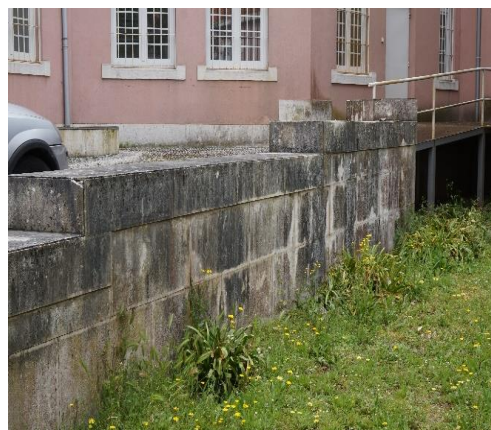
Figura 88 - Colonização biológica, manchas negras e sujidade na pedra de calcário
