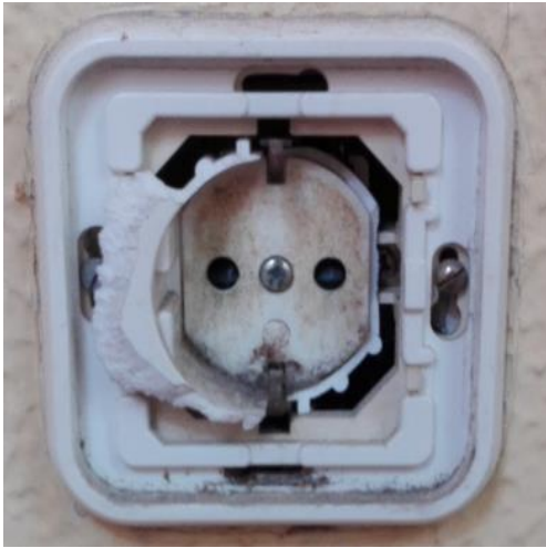
Figura 75 – Sinais de colisão no espelho da tomada elétrica [Autor, 2016]
