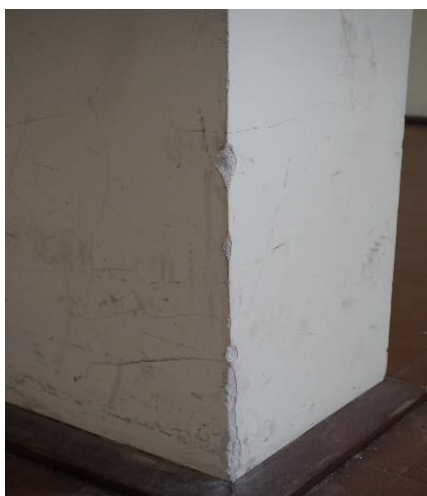
Figura 31 – Destacamento do revestimento na empena da parede
