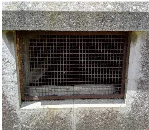
Figura 79 – Oxidação do gradeamento da janela da cave
