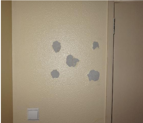
Figura 50 – Descasque da pintura na parede [Autor, 2016]
