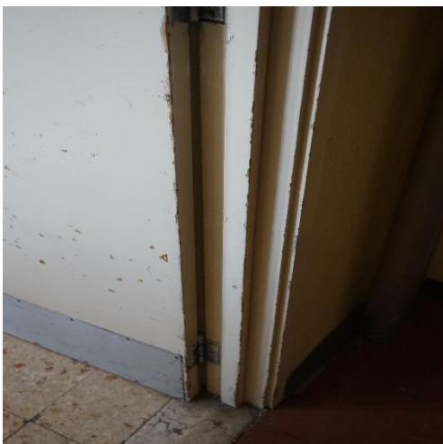
Figura 67 – Deterioração da porta de madeira
