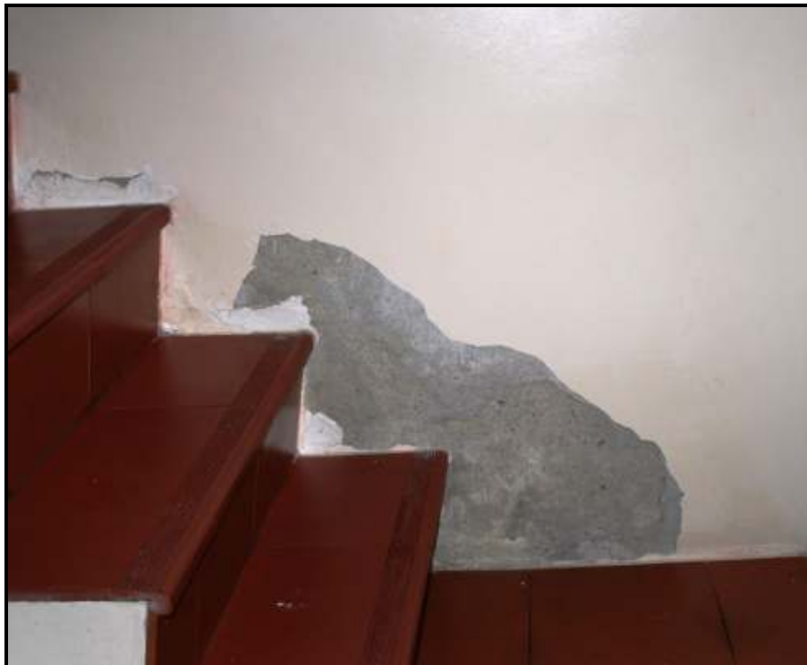
Figura 4.4: Degradação de uma parede , de autor
