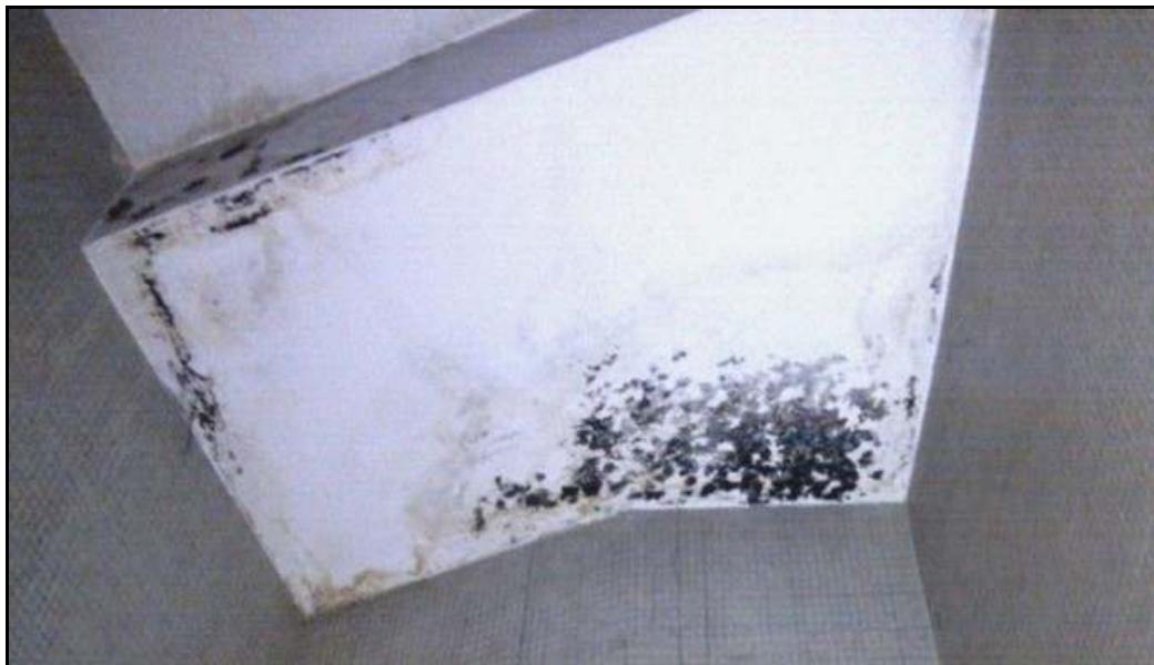
Figura 3.4: Bolores no interior devido a problemas de condensação, de autor
