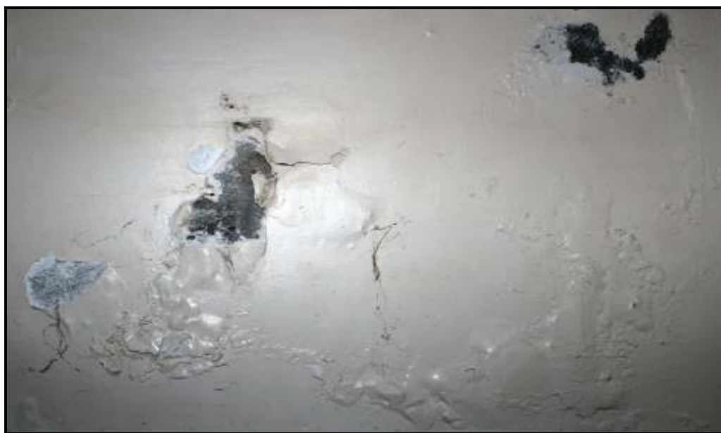
Figura 6.3: Parede com desagregação do revestimento, de autor
