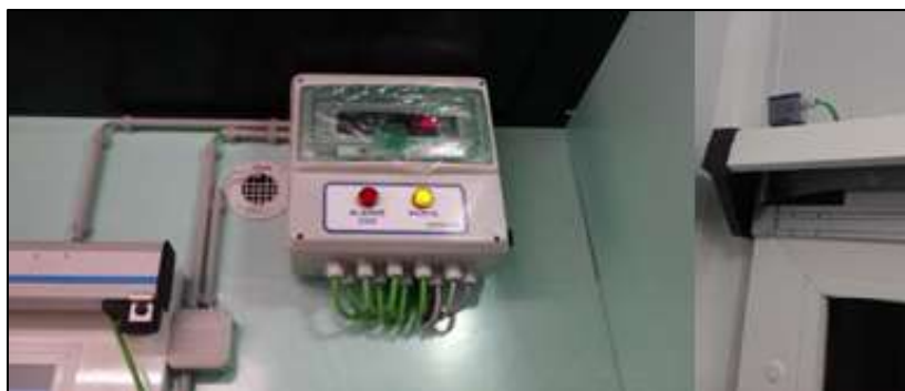
Figura 17 - Quadro elétrico de uma câmara com indicação de porta aberta (à esquerda) e interruptor fim de curso (à direita).
