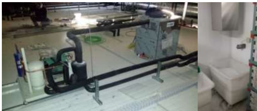
Figura 40 - Unidade de condensação da máquina de gelo e máquina de gelo do tipo split (à esquerda). Condução da máquina de gelo split e o carrinho de gelo (à direita)
