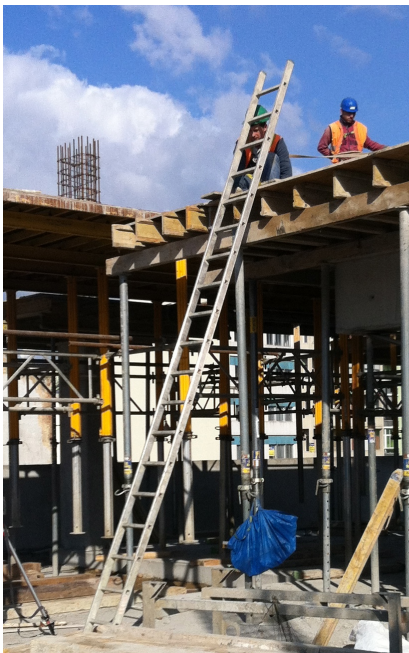
Figura 62 Escada pouco segura
