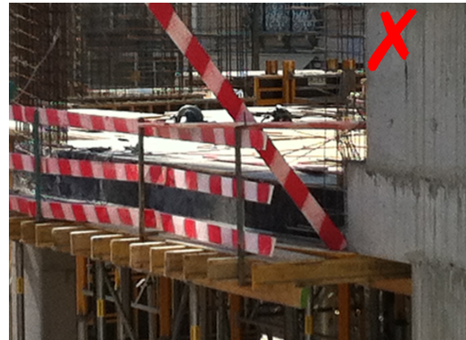
Figura 69 Exemplo de uma montagem incorrecta de guarda-corpos numa esquina
