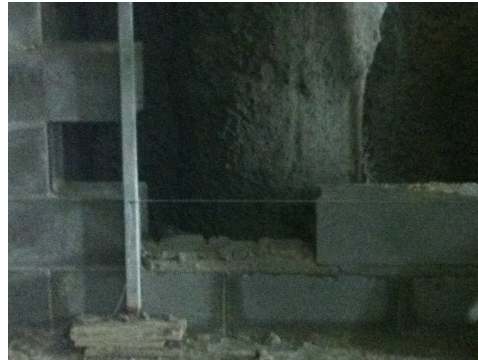
Figura 64 Parede de blocos de betão mal executada
