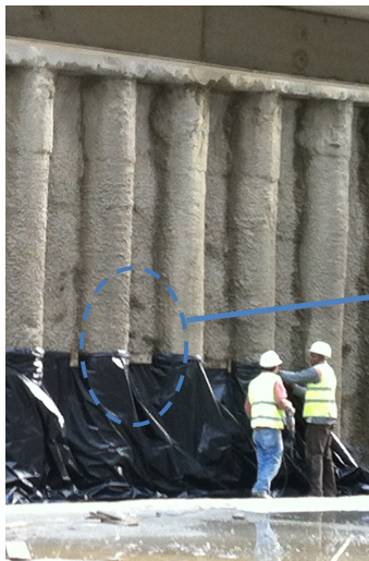
Figura 51 Cortina de estacas com plástico para impedir a passagem de água ou argamassa
