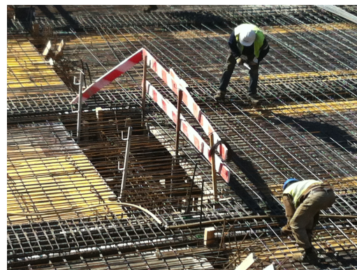
Figura 54 Protecção parcial e ineficácia da protecção
