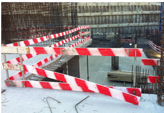
Figura 55 Ineficácia da protecção - má montagem do guarda-corpos
