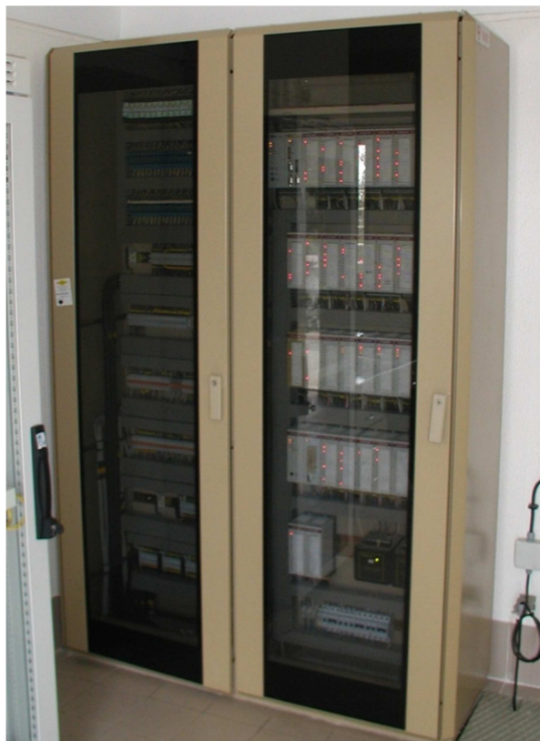
FOTO 5.1 – QUADRO DO AUTÓMATO DO POSTO DE CLORAGEM DE ALHANDRA (ARQUIVO PESSOAL, 2007)
