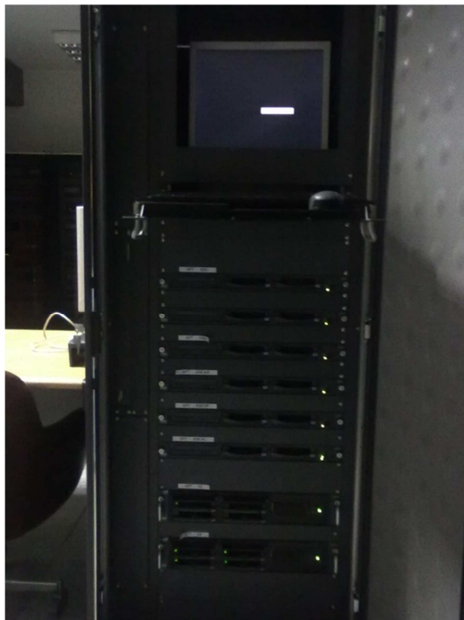
FOTO 5.5 – I/O SERVERS E SERVIDORES APLICACIONAIS DO CITECT SCADA (FOTO GENTILMENTE CEDIDA POR VÍTOR SANTOS, 2012)
