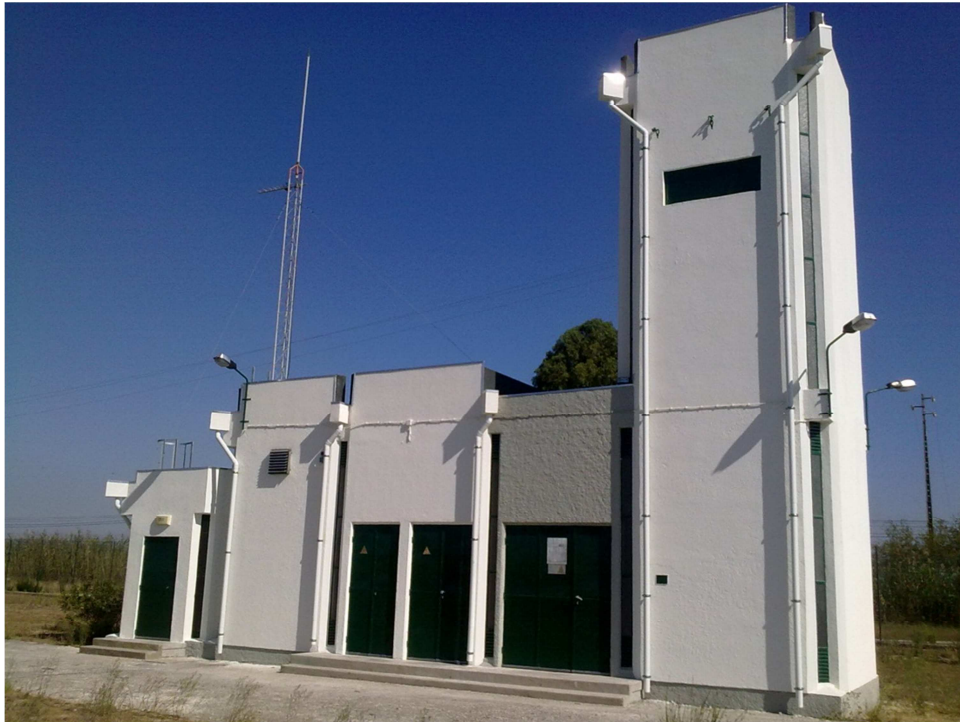
FOTO 5.4 – ANTENA DE RÁDIO EXISTENTE NO G3 DAS CAPTAÇÕES DAS LEZÍRIAS II (ARQUIVO PESSOAL, 2012)
