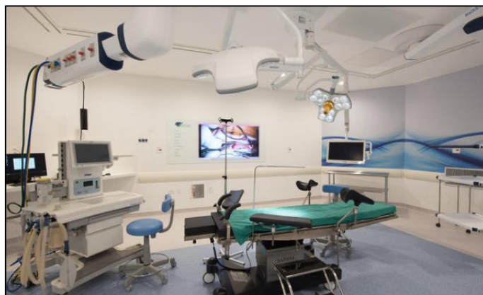
Figura 3.4- Salas limpas em bloco operatório [36].
