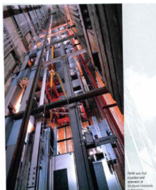
Figura 2.13: Vista do interior de uma caixa com o sistema de guiamento, de cabina e contrapeso, e respectivas fixações
