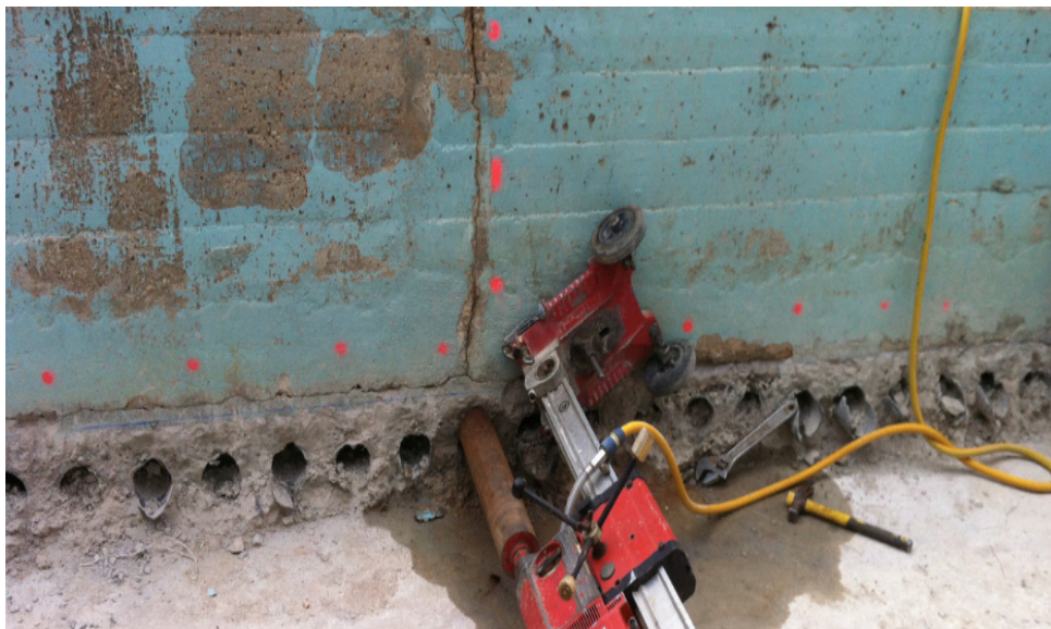
Figura 4.2 - Fissura longitudinal nos muretes de caleira central.
