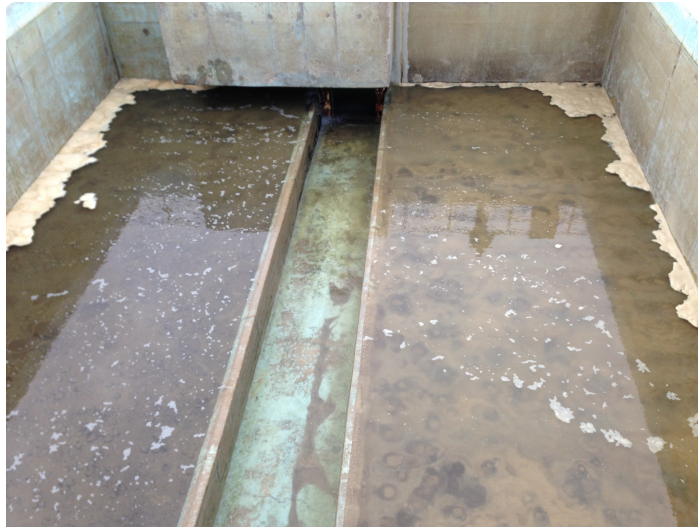
Figura 2.16 - Tanque com água ao nível dos muretes
