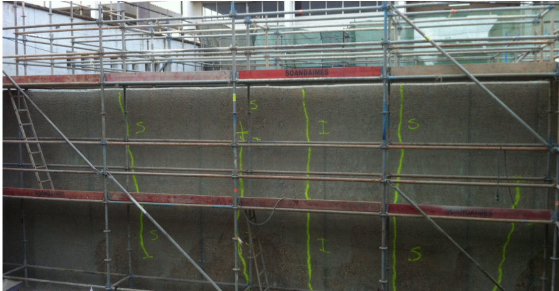
Figura 3.14 - Mapeamento de fissuras.
