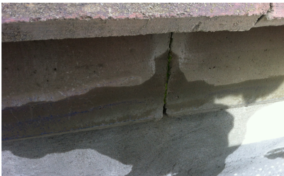
Figura 4.5 – Escorrências através das juntas da caleira.
