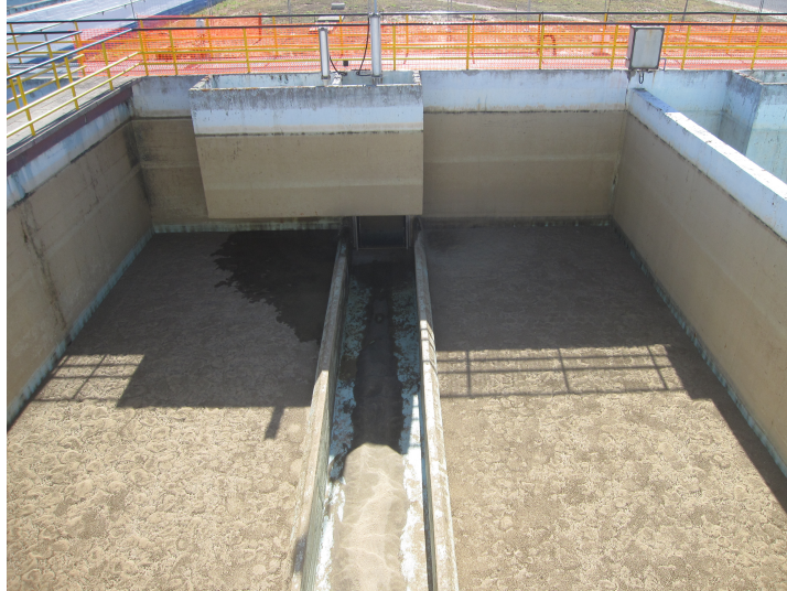
Figura 2.7 - Vista do tanque.
