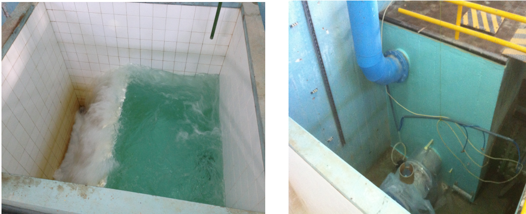
Figura 2.10 - (a) Descarregador de acesso ao depósito. (b) Prolongamento da cuba para o interior da galeria.
