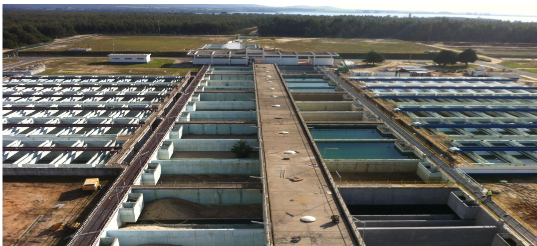
Figura 2.3 - Vista da estação
