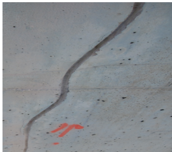
Figura 3.15 - Avivamento de fissuras.
