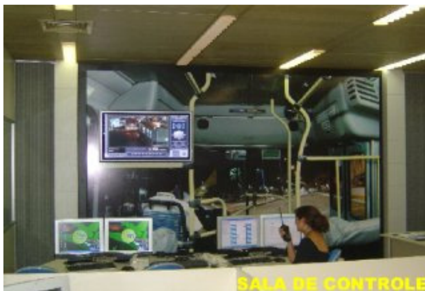
Fig. 6 - Sala de Controle (Câmara dentro do autocarro).
