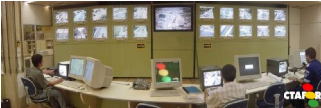
Fig. 7 - Sala de Controlo CTAFOR.
