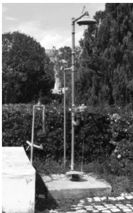
Figura 20.3 Chuveiro e lavador de olhos
