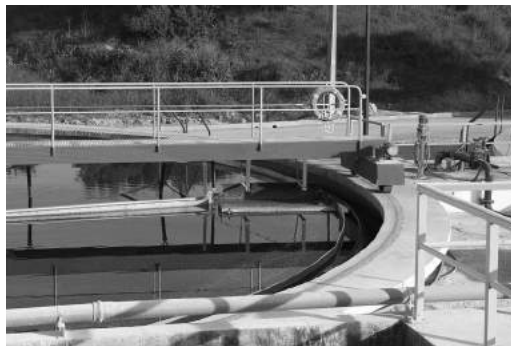
Figura 11.16 Soleira de deslocação da ponte raspadora
