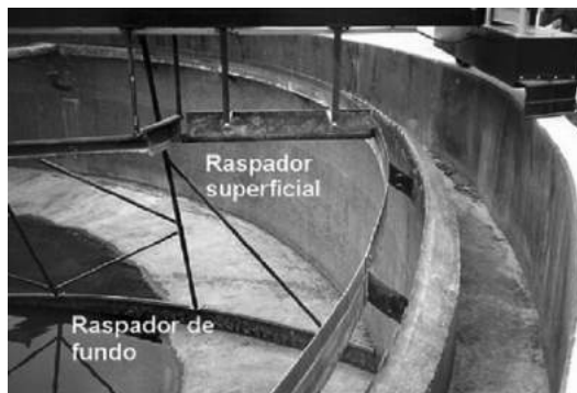
Figura 11.17 Raspadores superficial e de fundo do decantador
