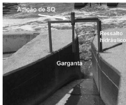
Figura 8.3 Misturador de ressalto hidráulico
