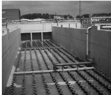
Figura 13.7 Difusores montados em tubagem distribuidora de ar
