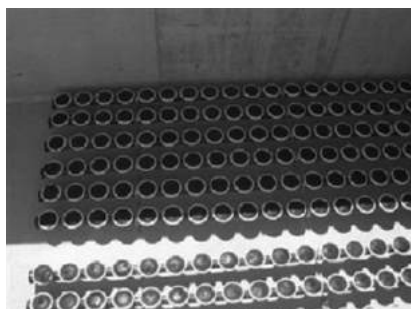
Figura 8.6 Difusores de ar comprimido
