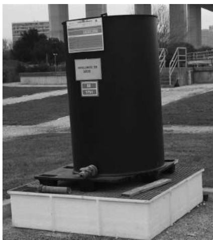
Figura 20.11 Contentor portátil e respetiva bacia de retenção
