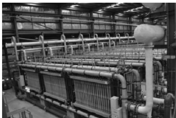
Figura 15.10 Bateria de módulos de membranas
