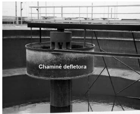
Figura 11.9 Defletor da entrada central do decantador
