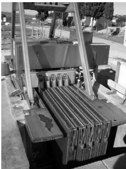
Figura 19.6 Instalação de desinfecção por UV
