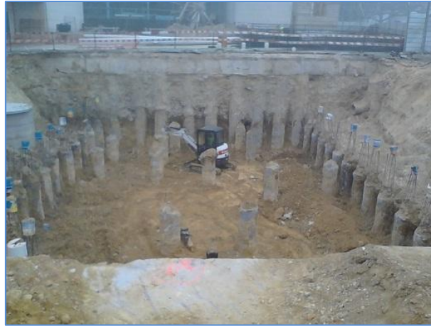
Imagem 18 - Estado inicial da zona da Saída do Metro.
