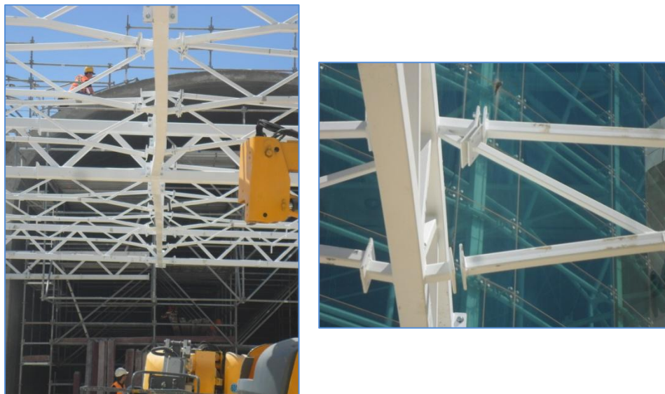
Imagem 17 - Defeitos Estrutura metálica.
