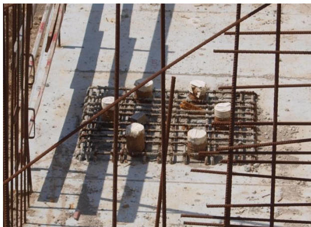
Figura 32 - Local de instalação dos AA
