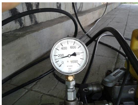
Figura 66 - Manómetro de pressão
