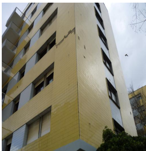
Fig. 18 - Fachada de um edifício alto onde se verifica descolamento de ladrilhos com perigo para os transeuntes.
