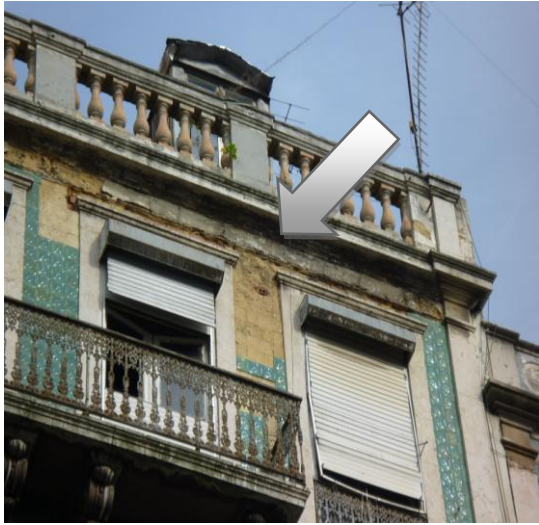
Fig. 24 – Desprendimento de ladrilhos devido à degradação generalizada do suporte do RCF em edifício antigo.
