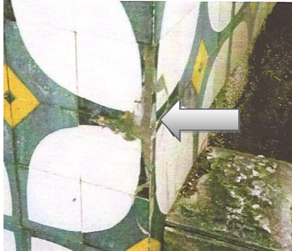
Fig. 26 – Desprendimento de fracções de ladrilhos em canto saliente de fachada
