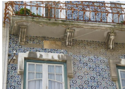
Manchas de Humidade
