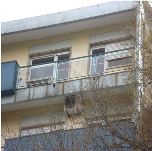
Manchas de humidade
