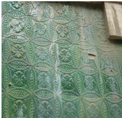
Manchas de humidade
