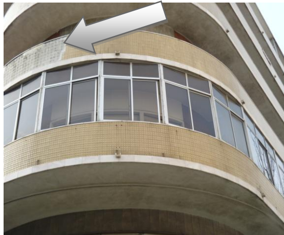
Fig. 15 - Descolamento em fachada curva.
