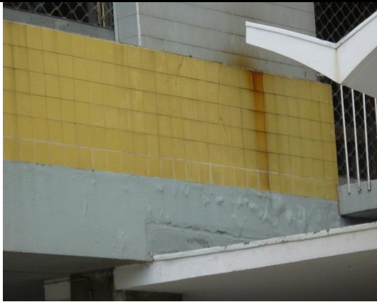
Manchas de humidade
