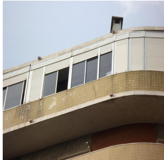
Manchas de humidade
