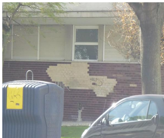
Fig. 21 – Desprendimento do revestimento na zona corrente de uma fachada.
