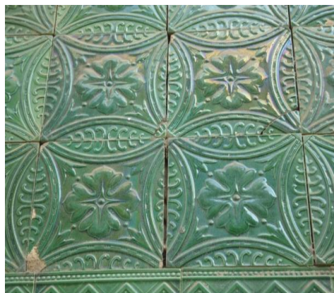
Deteriorização das juntas
