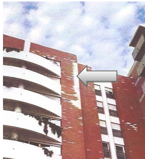
Fig. 20 – Desprendimento junto a canto saliente de uma fachada de um edifício recente [12]
