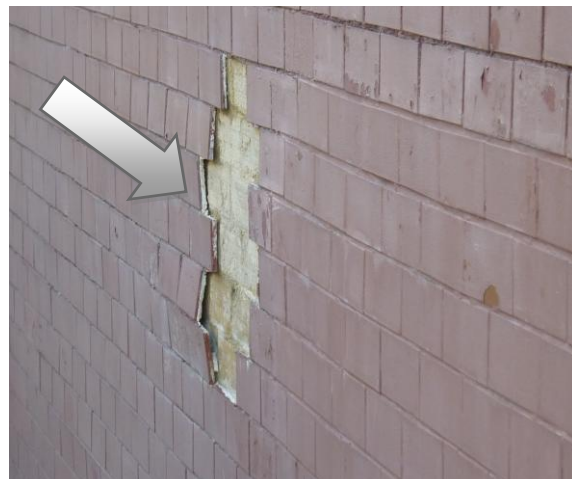
Fig. 23 - Descolamento com empolamento de um grupo de ladrilhos, em parâmetro exterior de parede
