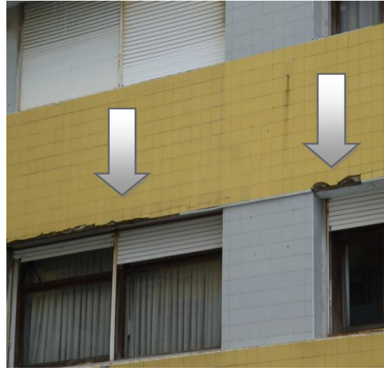
Fig. 25 – Desprendimento e queda de fracções devido à corrosão das armaduras de elemento construtivo em betão armado.
