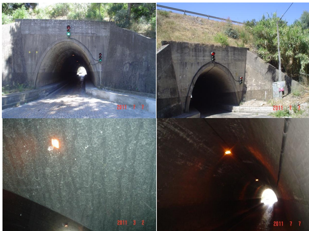
Figuras CE.5.2 – Semáforos e iluminação do Túnel
