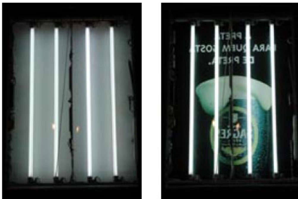
Figura 4.17 – Equipamento de iluminação de Abrigos e MUPI's
