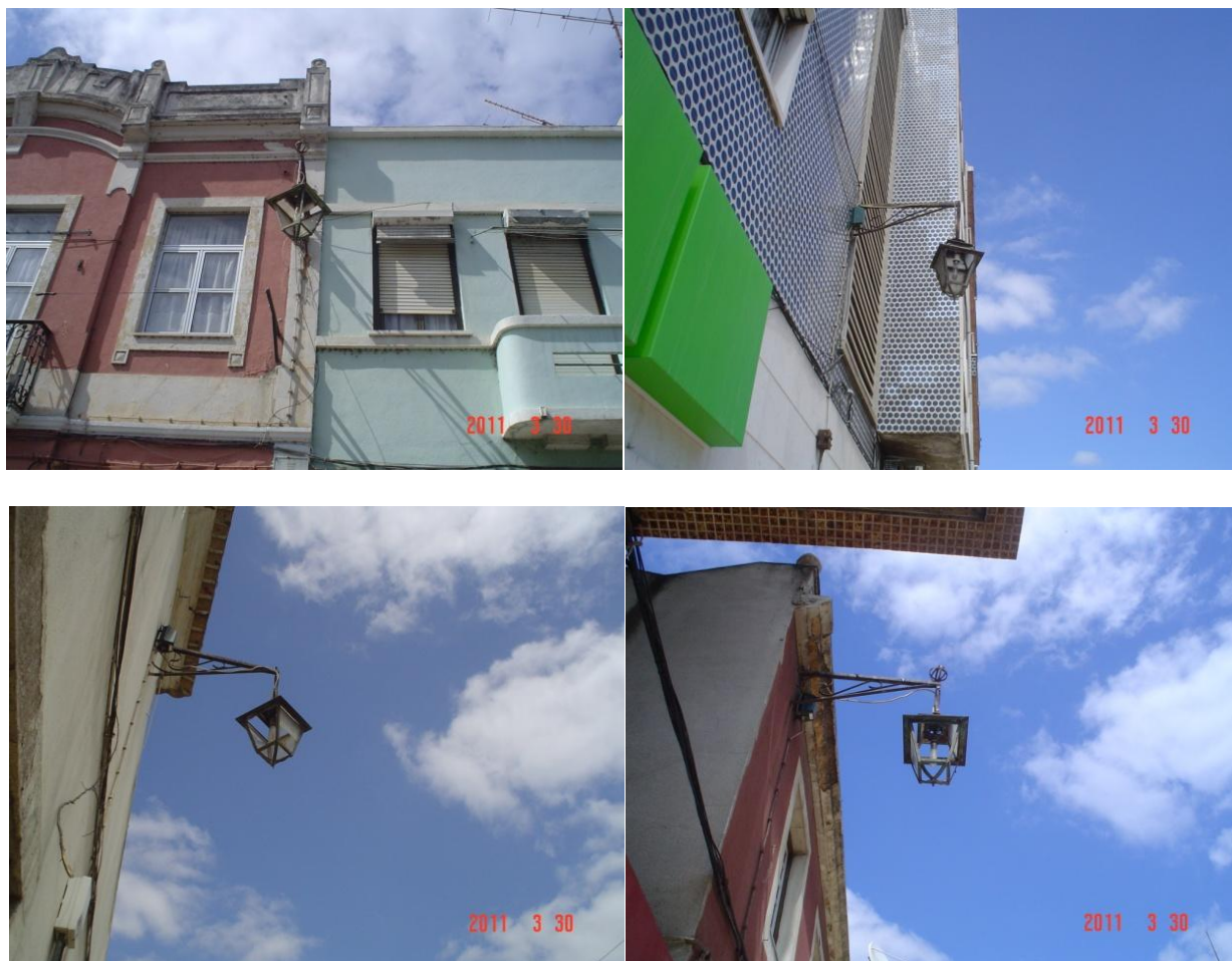
Figuras CE.2.2 – Estado de conservação de alguns dos pontos de luz
