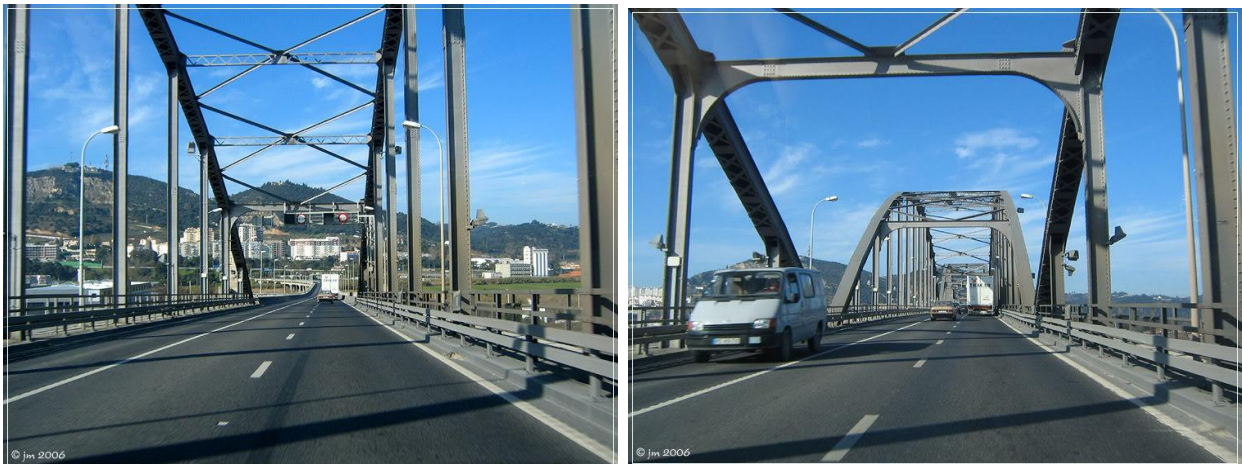
Figuras CE.4.3 - Característica da iluminação actual (lanço da Ponte)
