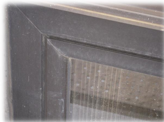
Figura 5.3.9. Falta de vedante (Reservado, 2016)
