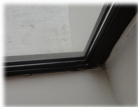
Figura 5.3.11. Falta de vedante entre o aro e o vão da janela (Reservado, 2016)
