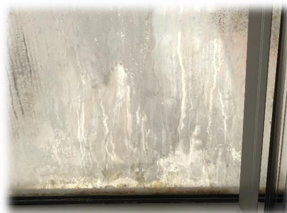
Figura 5.3.4. Vidro com condensação no interior da caixa de ar (Fonte: Autora, 2017)
