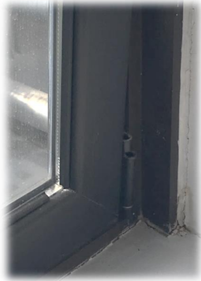
Figura 5.3.24. Degradação das ferragens (Fonte: Autora, 2017)
