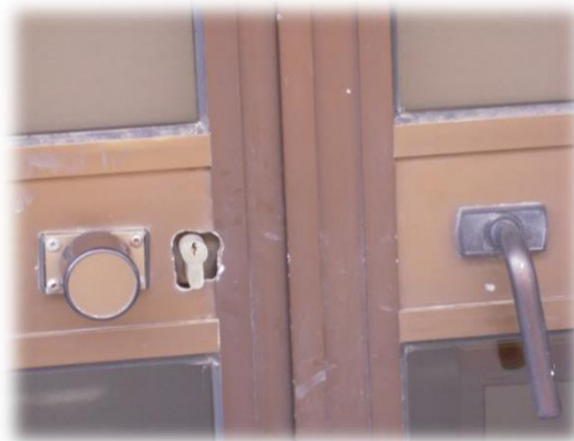
Figura 5.3.25. Maçaneta e fechadura da porta irregulares (Reservado, 2016)
