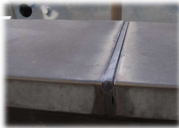
Figura 5.3.16. Folga entre rufo e caixilharia (Reservado, 2016)
