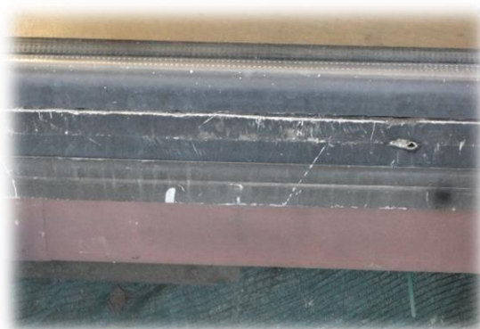
Figura 5.3.27. Camada de anodização degradada (Reservado, 2016)
