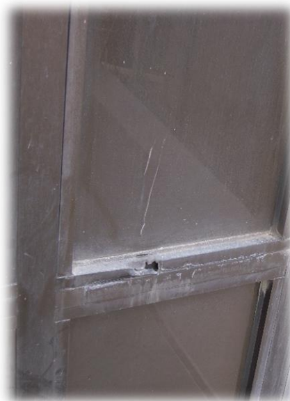
Figura 5.3.22. Deformações na caixilharia (Reservado, 2016)
