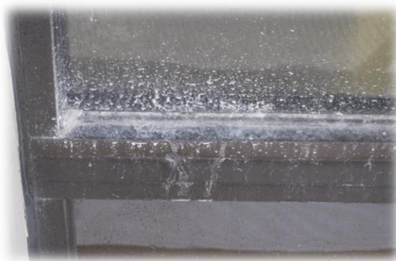
Figura 5.3.21. Depósito cimentício nos perfis (Reservado, 2016)
