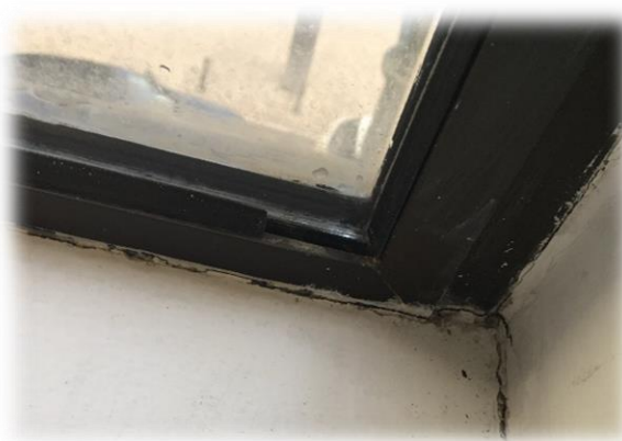
Figura 5.3.10. Perfil vedante defeituoso (Fonte: Autora, 2017)
