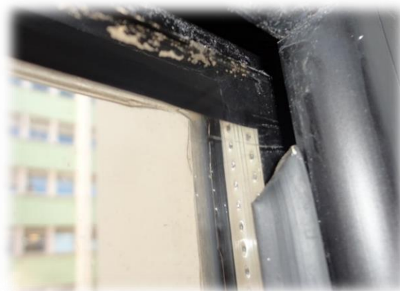
Figura 5.3.3. Vidro parcialmente solto (Reservado, 2016)
