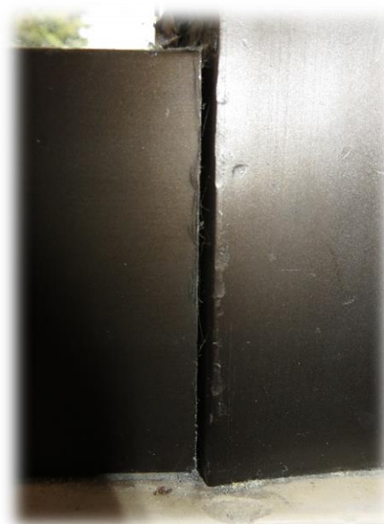
Figura 5.3.15. Folga ou deficiente selagem da junta fixa (Reservado, 2016)
