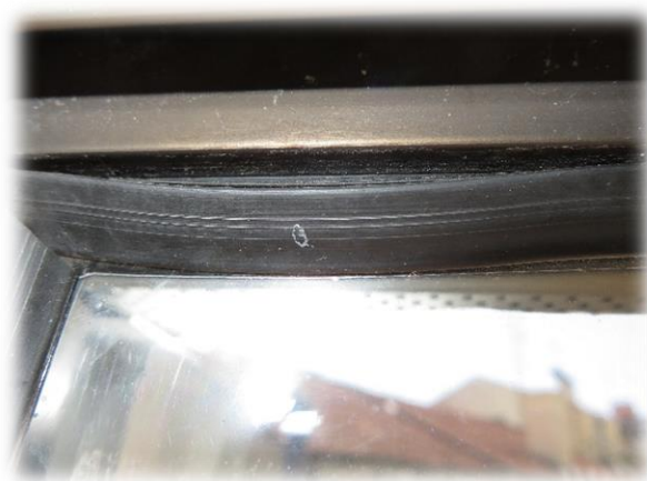
Figura 5.3.8. Vedante descolado ou deformado (Reservado, 2016)
