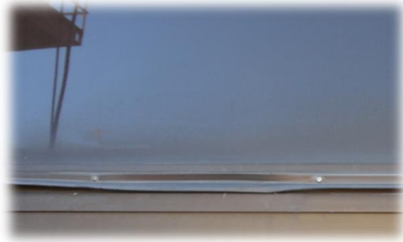
Figura 5.3.7. Deficiente instalação de pingadeiras (Reservado, 2016)
