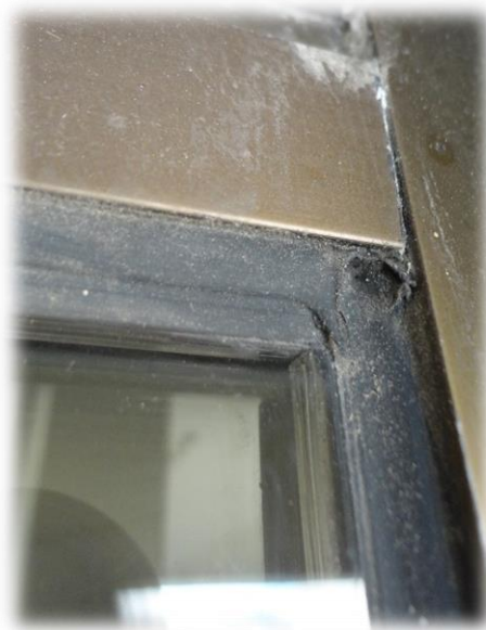
Figura 5.3.12. Vedante substituído por mástique na junta dos vidros (Reservado, 2016)
