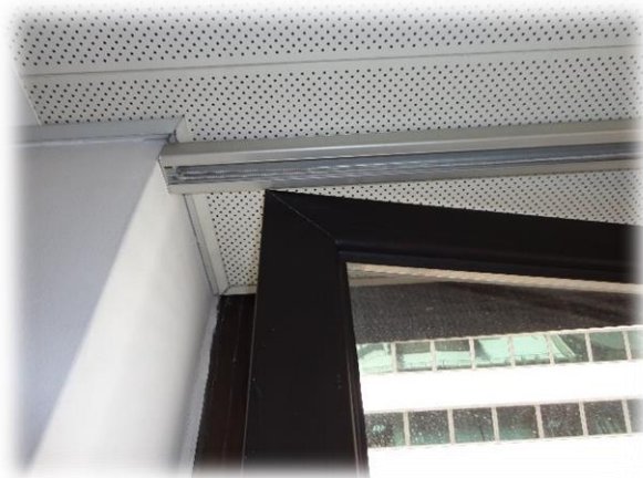
Figura 5.3.6. Normal abertura da janela obstruída (Reservado, 2016)
