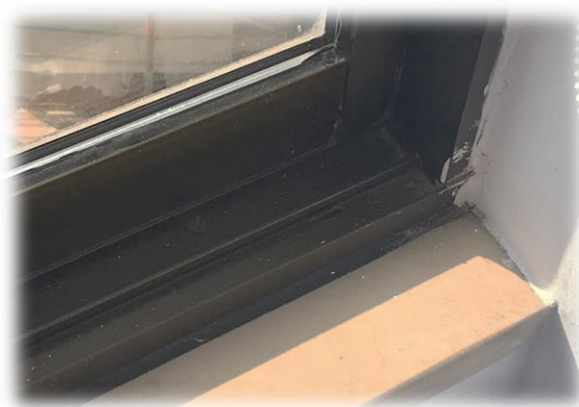
Figura 5.3.14. Falta de calço de vedação em folhas de correr (Fonte: Autora, 2017)
