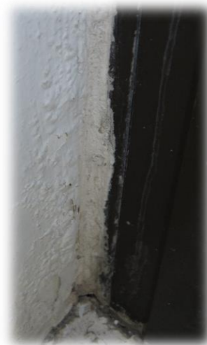
Figura 5.3.20. Infiltração de água (Fonte: Autora, 2017)
