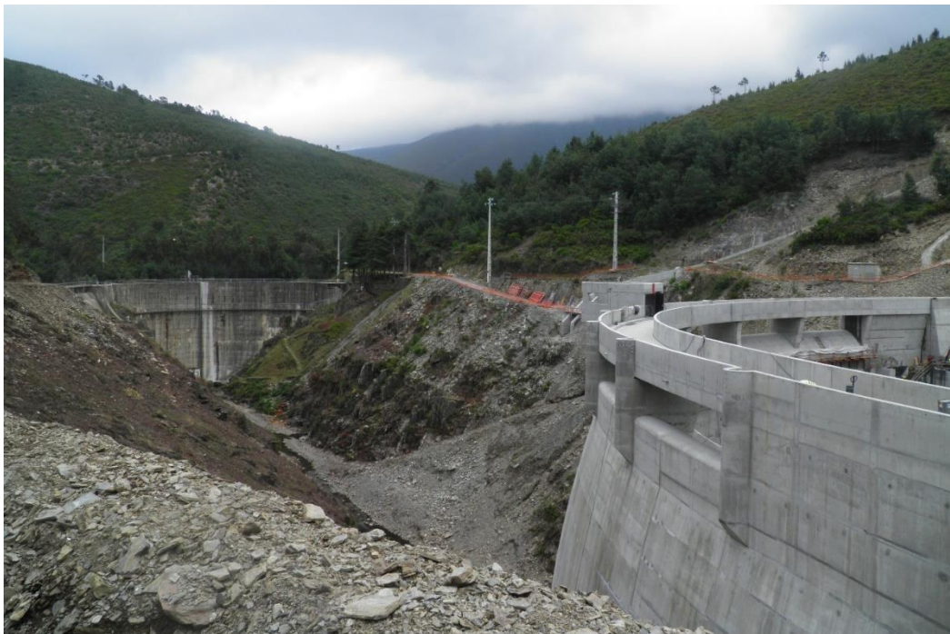
Figura 1.1: Barragem de Alto Ceira II. Vista da antiga barragem, em fase avançada de deterioração devido a reações expansivas, e vista da nova barragem na fase final da construção para substituição da antiga.
