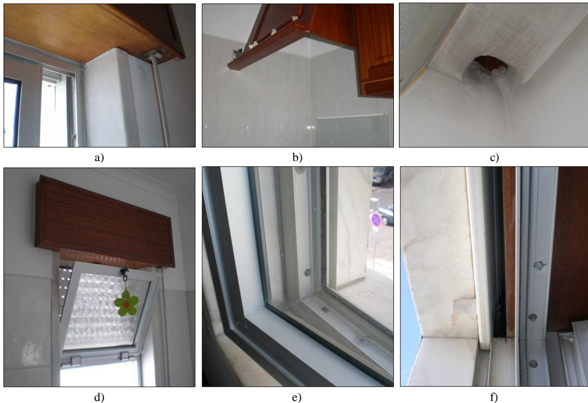
Figura 2 – Fotografias dos principais componentes da envolvente. a) Caixa de estore e janela de correr com caixilharia em alumínio e vidro comum. b) Abertura da chaminé do fogão. c) Abertura da conduta de exaustão da chaminé. d) Janela basculante em alumínio e vidro comum (instalação sanitária). e) Janela de abrir de uma folha em alumínio e vidro comum (sala – fachada NO). f) Pormenor da abertura da caixa de estore no exterior.
