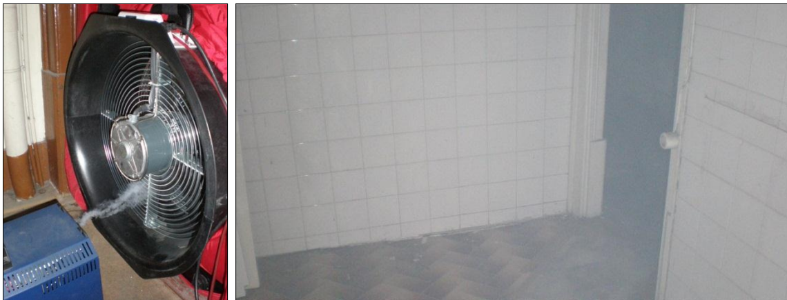
Figura 8 – Gerador de fumo branco e ventilador, insuflando o espaço interior com fumo. Neste exemplo, dada a permeabilidade do pavimento, o fumo branco foi detectado no piso inferior.
