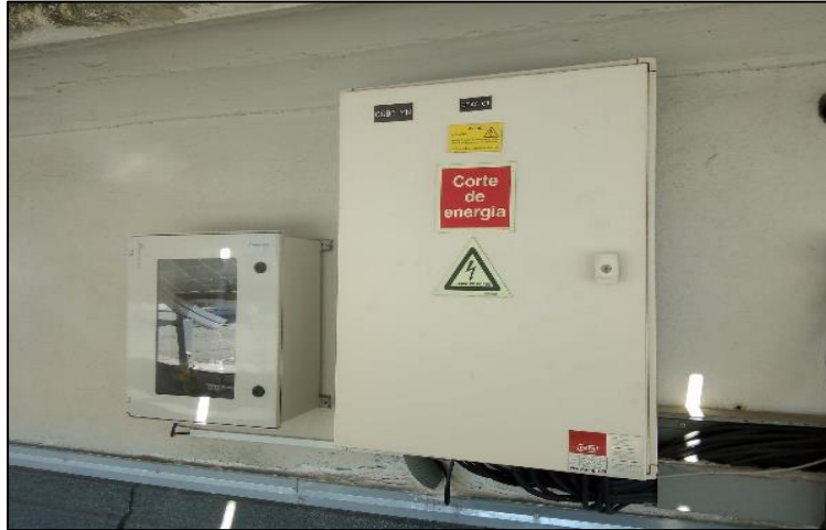
Figura 4-32 - Quadro de corte geral do sistema fotovoltaico instalado na cobertura do edifício C1
