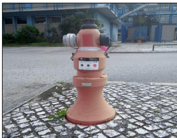
Figura 4-25 - Marco de incêndio localizado junto ao edifício C1
