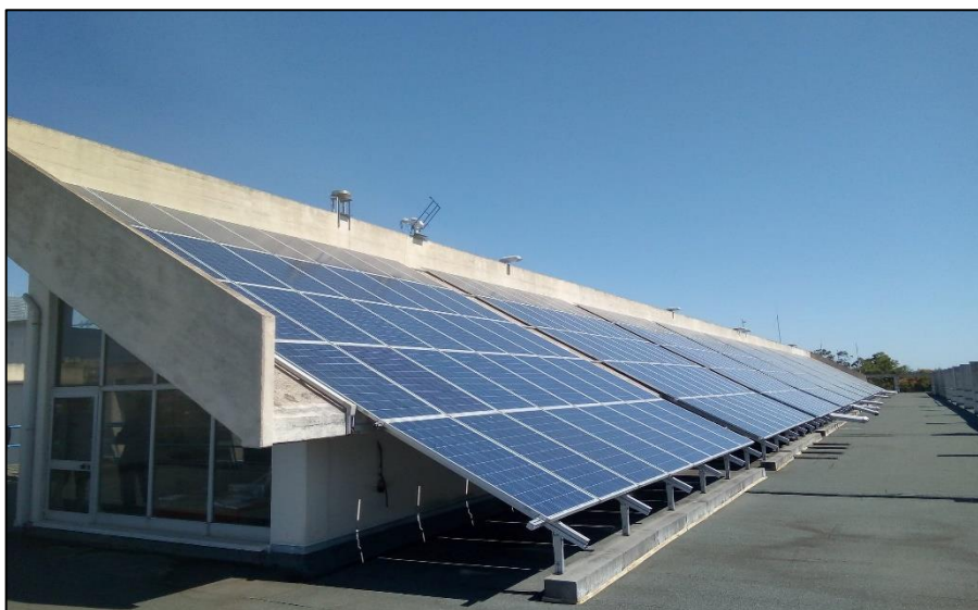
Figura 4-23 - Unidade de produção da Faculdade de Ciências da Universidade de Lisboa colocada na cobertura do edifício C1
