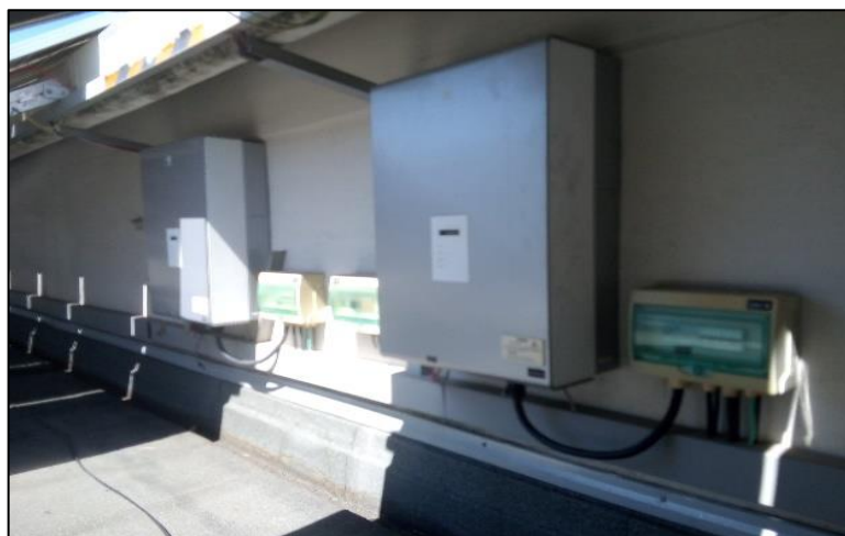
Figura 4-28 - Inversores e quadros AC/DC
