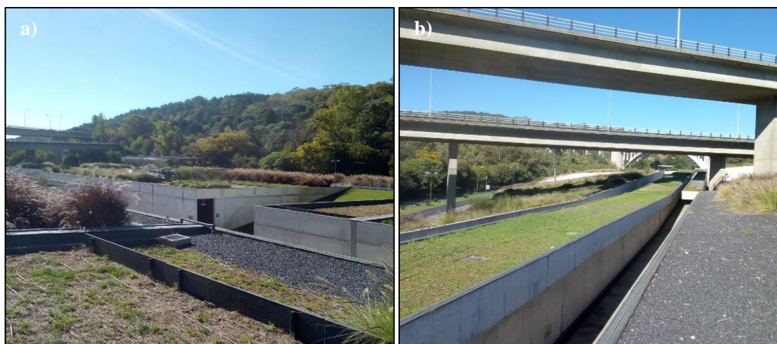
Figura 4-16 - Cobertura sem "guardas" contra quedas: a) Cobertura dos parques de estacionamento e do edifício administrativo e de monitorização; b) Cobertura do edifício de operação
