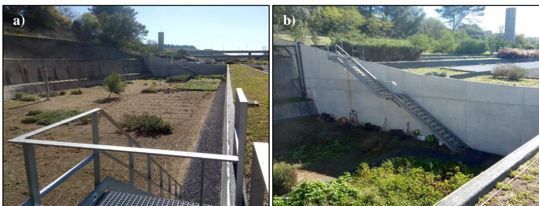
Figura 4-11 - Escadas exteriores de acesso à cobertura ajardinada: a) Junto ao Viaduto Duarte Pacheco; b) Próxima da entrada principal das instalações
