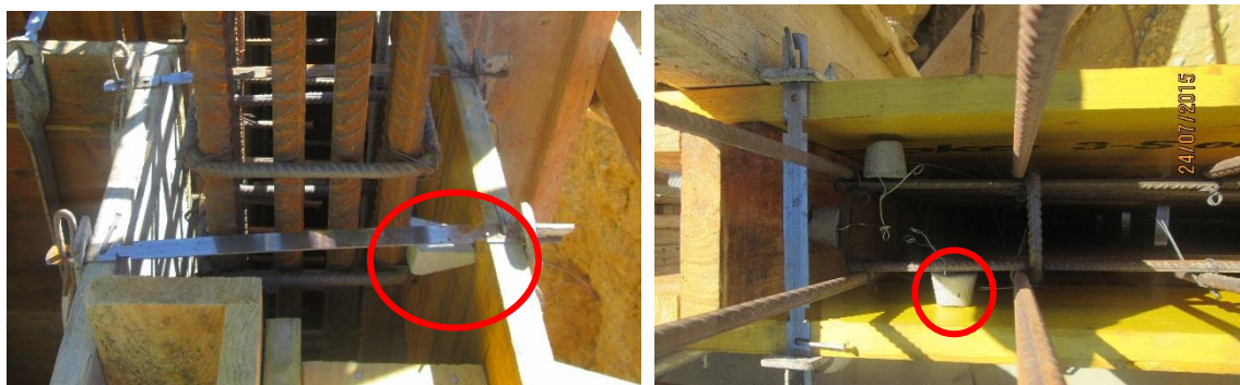
Fotografia 6 - Espaçadores colocados de forma errada
