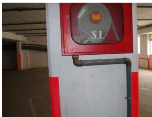
Figura 2.10 - Boca-de-incêndio armada alimentada por conduta em PVC (Varela e Rodrigues, 2011)
