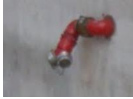
Figura 3.9 – Boca Siamesa 3" Compacta com Válvula de Retenção e 2 Adaptadores Storz 75 mm com tampões, instalada na Avenida Afonso Costa em Lisboa
