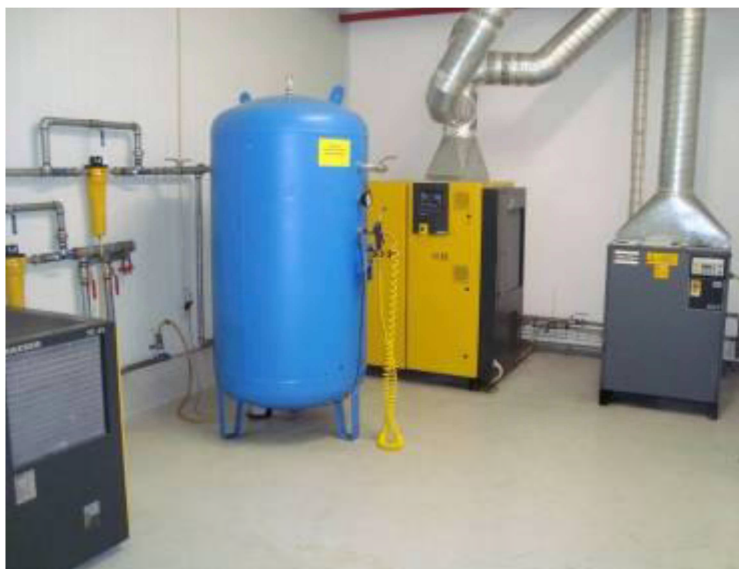
Figura 13: Compressor de ar
