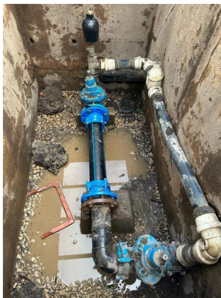
Figura 4.35 – VRP retirada (retirada em 2023).
