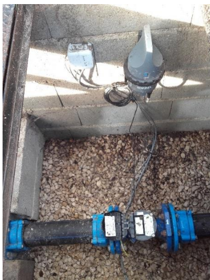
Figura 2.21 – Medidor de caudal ultrassônico ligado a sistema de telemedição.
