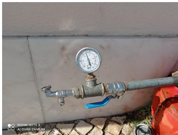
Figura 4.42 – Medição de pressão em marco de incêndio.
