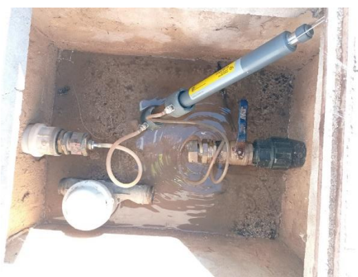
Figura 4.64 – Instalação de sonda multiparâmetros para medição de cloro.
