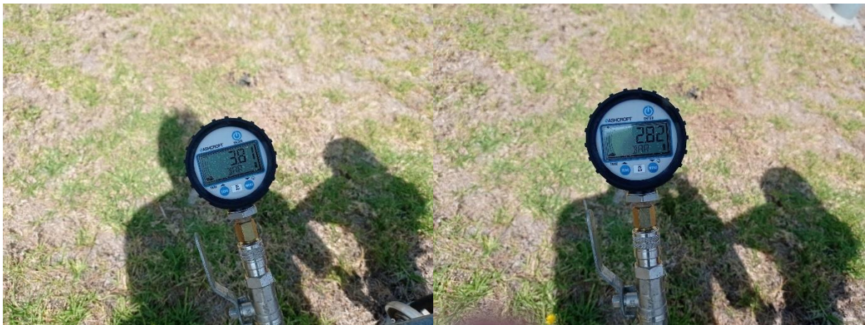
Figura 5.19 – À esquerda temos a leitura da pressão em bar antes da abertura do marco de incêndio e à direita temos a leitura da pressão em bar depois da abertura do marco de incêndio (tiradas em 2024).
