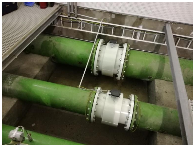
Figura 2.20 – Medidores de caudal eletromagnéticos à saída de reservatório.
