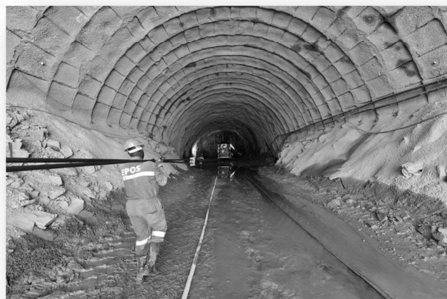
(cap. 2.5) - Fotografia 7 - Primeira fase de escavação com recurso a cambotas treliçadas. Emboquilhamento nascente, Vila Real. Foto do autor 2009.
