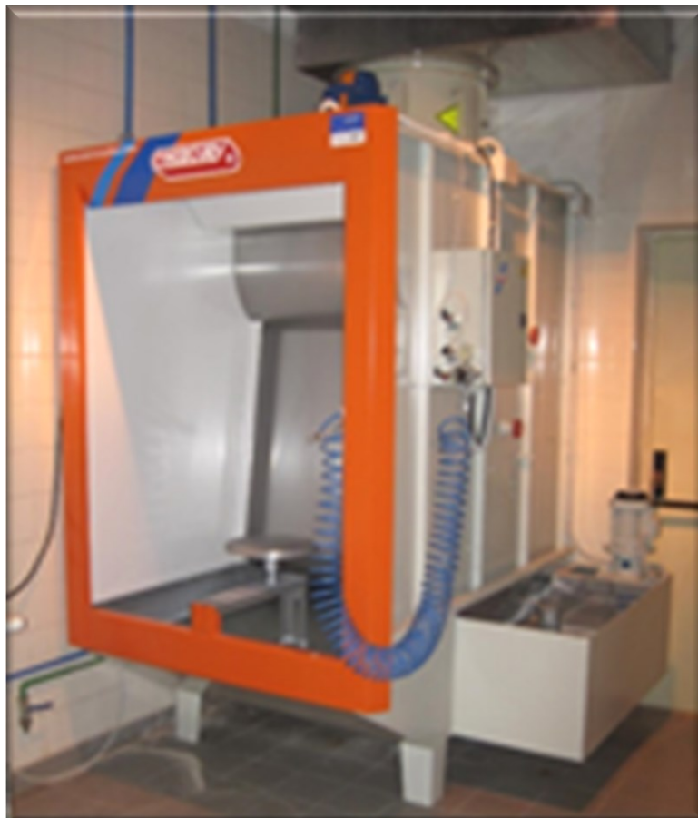
Figura 25 - Sistema de filtração de mercúrio, com cortina de água, facultado pelo ISQ
