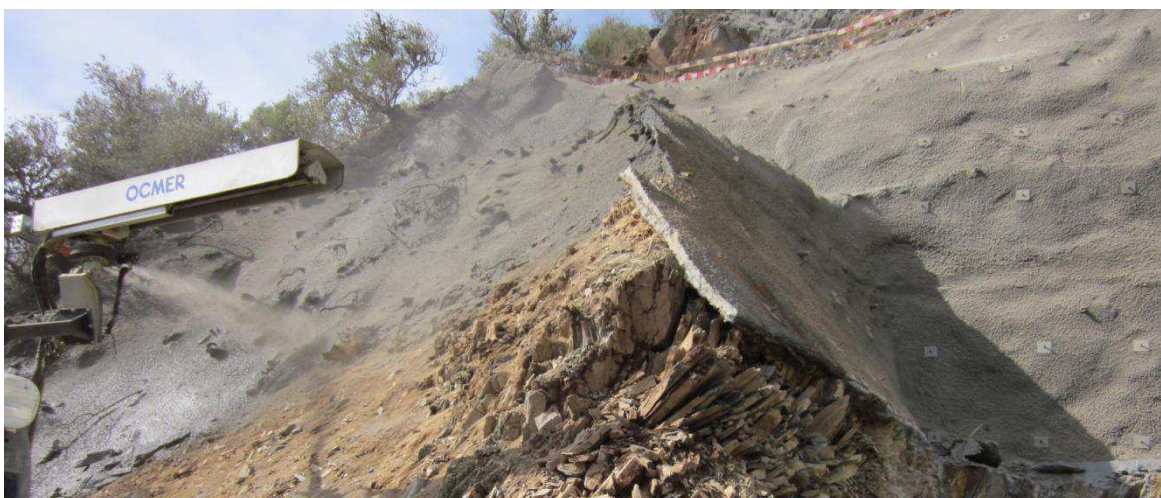
Figura 55 – PROC – Pregagens associadas a projeção de betão armado com fibras de aço
