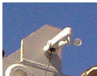
Figura 91 – PROC – Anemômetro instalado no topo do CA
