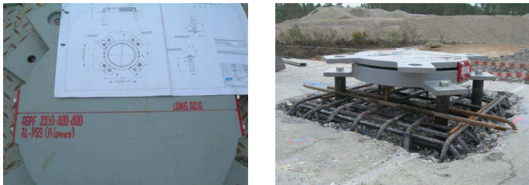
Figura 39 – Aparelhos de Apoio.
