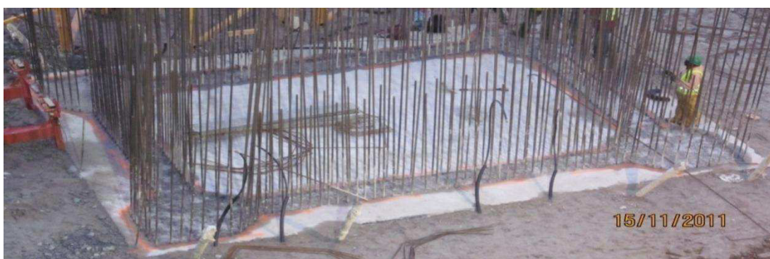
Figura 71 – PROC – Implantação e nivelamento geral da base de apoio da cofragem deslizante
