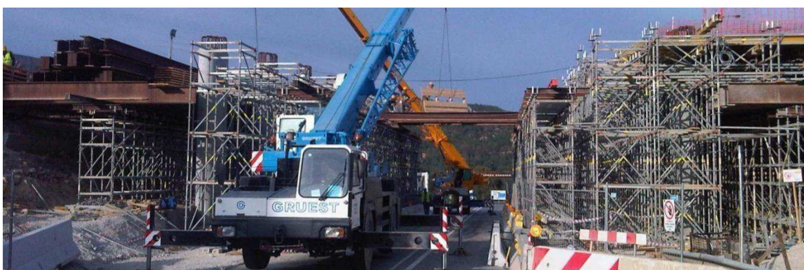
Figura 20 – PI 13 – Colocação dos perfis de apoio à cofragem sobre a via rodoviária
