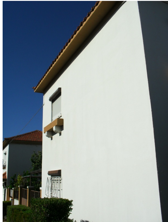
Figura 12 – Estado de conservação do revestimento exterior
