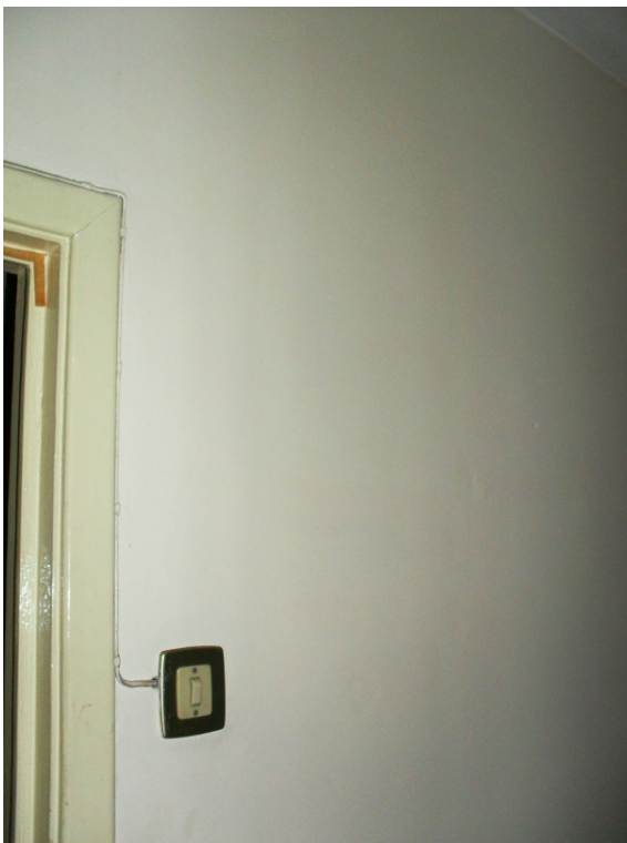
Figura 13 – Estado de conservação do revestimento interior
