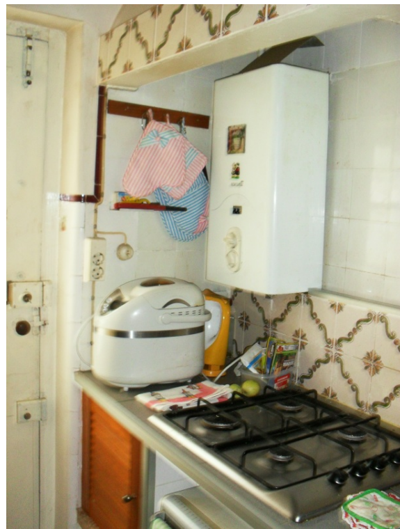
Figura 14 – Estado de conservação dos equipamentos de cozinha
