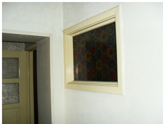
Figura 10 – Estado de conservação dos vãos interiores
