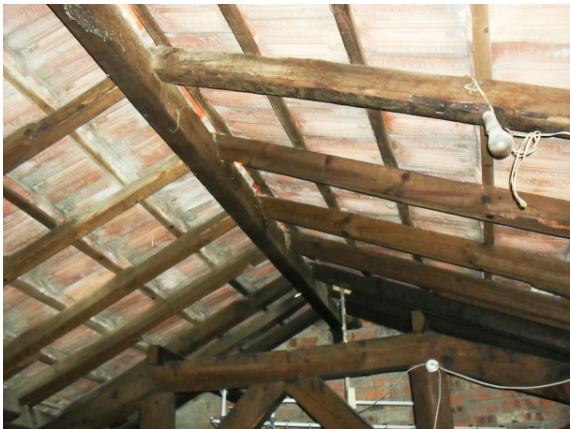
Figura 8 – Estado de conservação da cobertura (interior)
