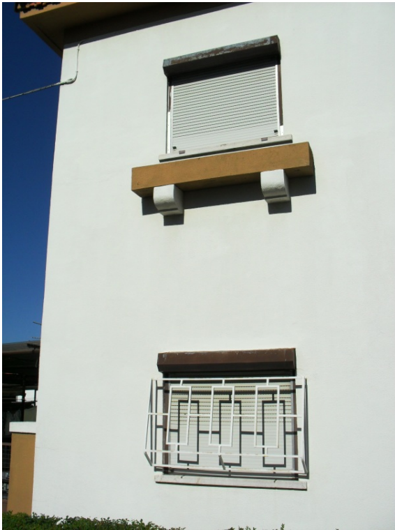
Figura 11 – Estado de conservação dos vãos interiores
