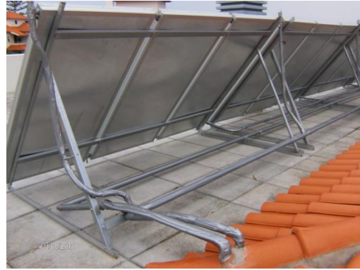
Figura 2.57 – Suporte e ligações painéis solares
