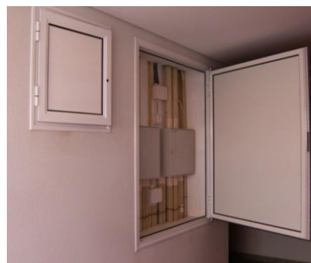
Figura 2.82 – Zona técnica, corete na galeria de um piso tipo
