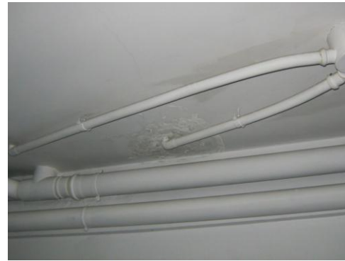
Figura 3.3 – Infiltrações em torno das tubagens de esgoto
