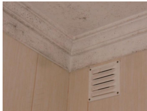
Figura 3.57 – Humidades no tecto de i.s.
