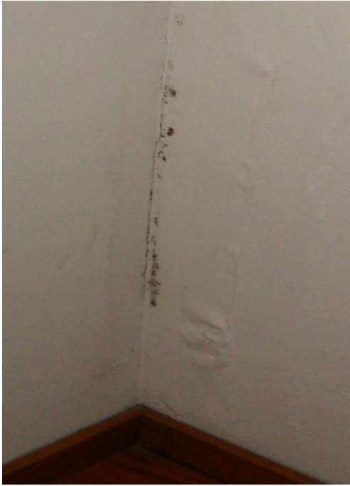
Figura 3.72 – Humidades nas paredes de quarto
