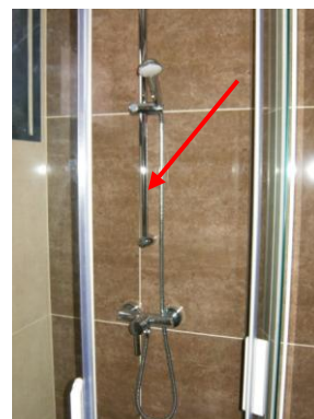
Figura 2.144 – Barra deslizante e misturadora da i.s. social
