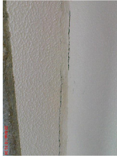
Figura 3.20 – Desagregação do mástique ao reboco
