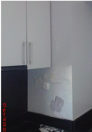
Figura 3.60 – Humidades na parede de cozinha
