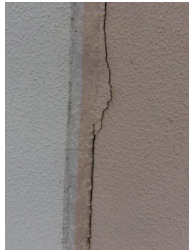
Figura 3.36 – Fissuração pelo reboco
