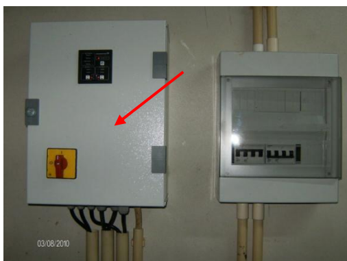
Figura 2.16 – Quadro da central hidropneumática
