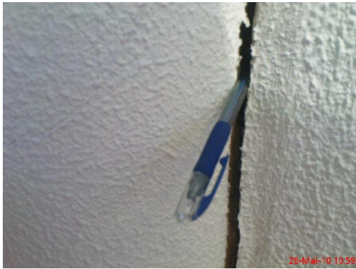
Figura 3.19 – Desagregação do mástique ao reboco
