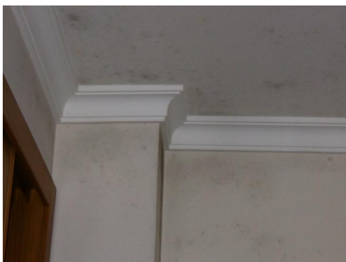
Figura 3.58 – Manchas no tecto e paredes da sala
