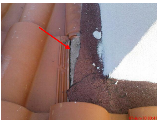
Figura 3.62 – Anomalia: má execução do remate junto à chaminé
