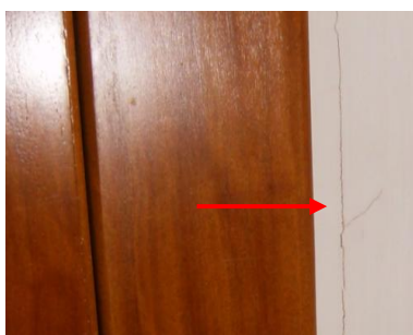
Figura 3.70 – Fissura vertical junto a guarnição de armário
