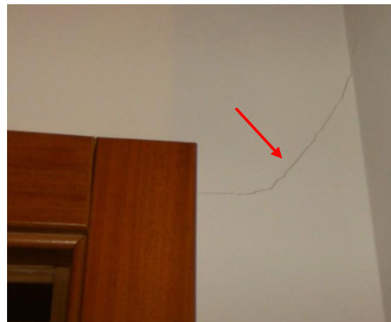
Figura 3.69 – Fissura junto a guarnição de porta
