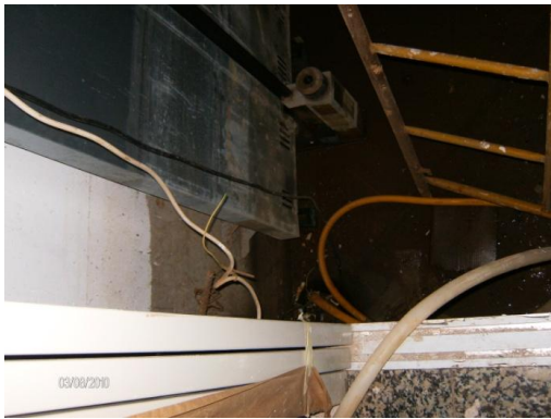
Figura 2.18 – Bomba poço elevador
