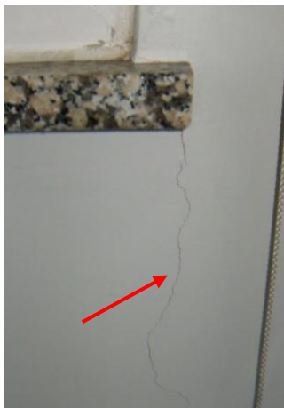
Figura 3.68 – Fissura vertical junto a soleira da janela
