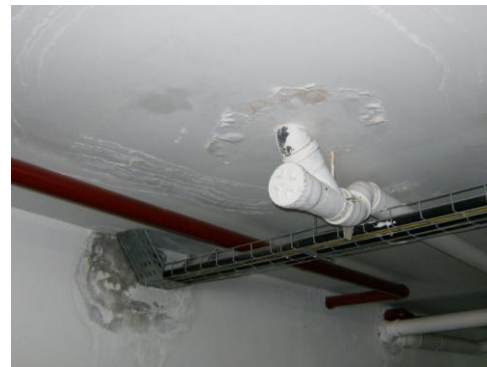
Figura 3.5 – Infiltração no tecto e parede da garagem
