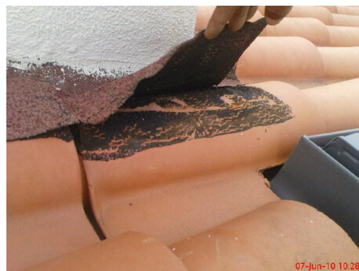
Figura 3.67 – Anomalia: descolagem da tela de impermeabilização
