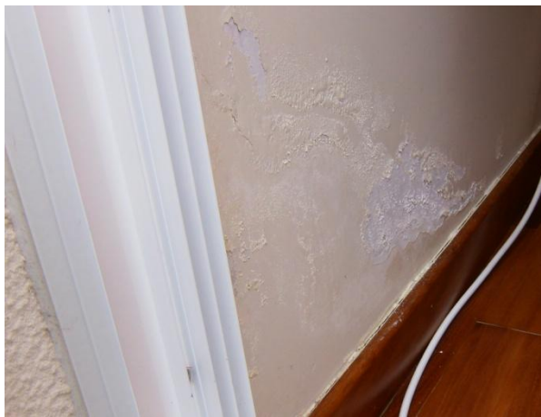
Figura 3.74 – Humidades em parede de sala
