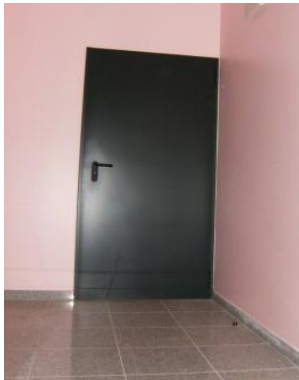
Figura 2.112 – Porta corta-fogo, pintura interior
