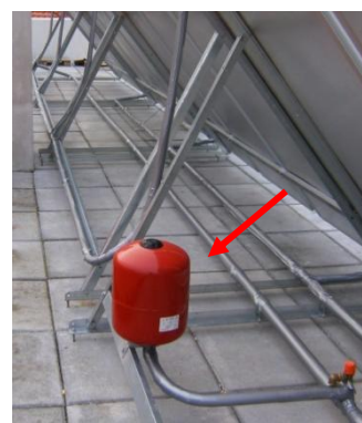
Figura 2.59 – Vaso de expansão de 35 litros
