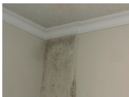
Figura 3.59 – Bolores junto ao paramento exterior
