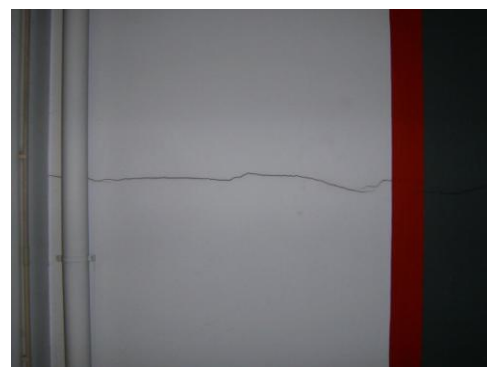
Figura 3.7 – Fissuração nas paredes da garagem
