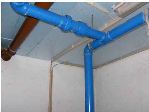
Figura 2.131 – Pintura interior, identificação rede de água potável e residual
