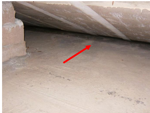
Figura 3.45 – Humidades no perímetro da laje do sótão
