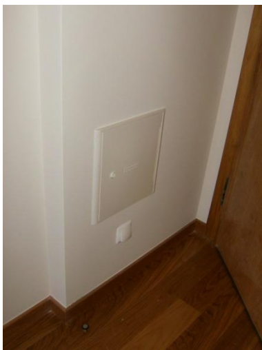
Figura 2.54 – Quadro de telecomunicações individual (fechado)
