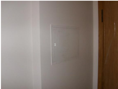
Figura 2.52 – Quadro eléctrico individual (fechado)
