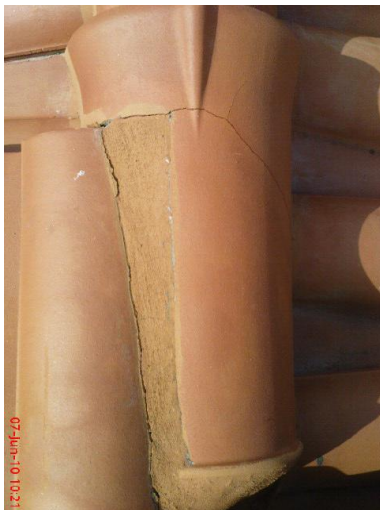
Figura 3.64 – Anomalia: telha fracturada com separação
