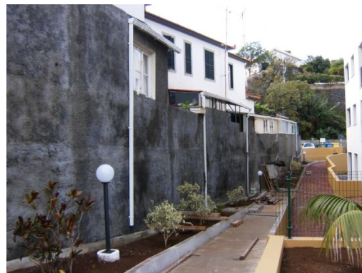
Figura 2.24 – Vista geral do escoamento das águas pluviais
