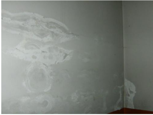
Figura 3.8 – Humidades nas paredes da garagem
