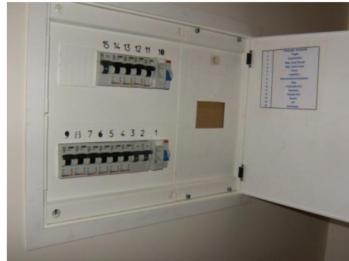
Figura 2.53 – Quadro eléctrico individual (aberto)
