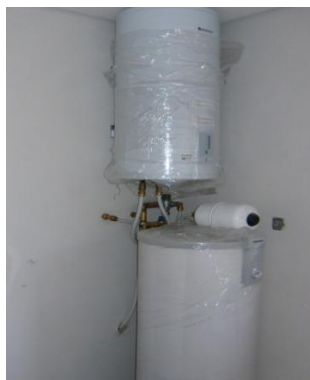
Figura 2.60 – Acumulador solar e termoacumulador eléctrico
