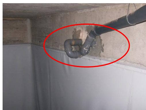
Figura 2.71 – Tanque águas pluviais
