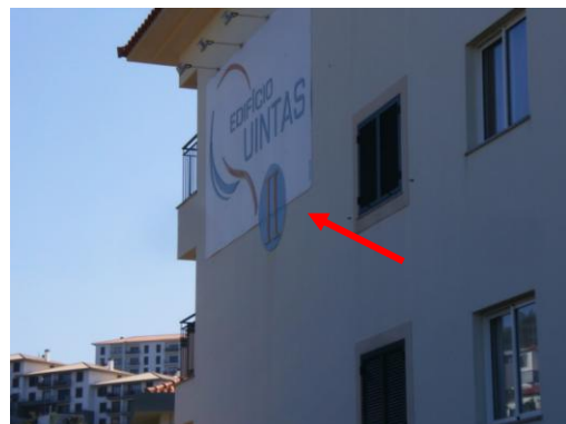
Figura 3.13 – Infiltração pelos apoios da placa identificativa do Edifício
