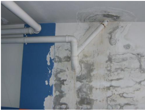
Figura 3.2 – Infiltrações em torno das tubagens de esgoto
