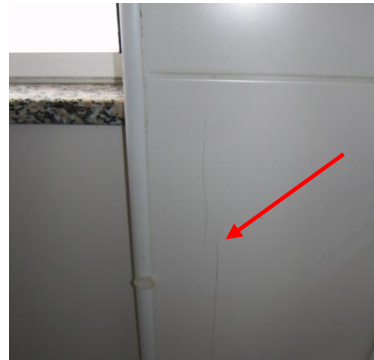
Figura 3.78 – Azulejo com fendilhação acentuada
