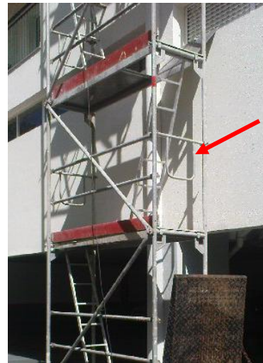
Figura 2.163 – EPC, guarda-corpos, edifício Quintas III
