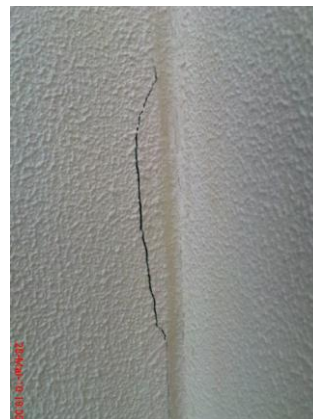
Figura 3.18 – Fissuração do reboco
