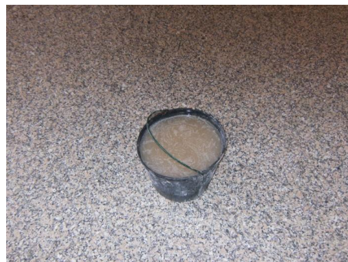
Figura 3.49 – Balde de água proveniente do enxugamento da laje do sótão
