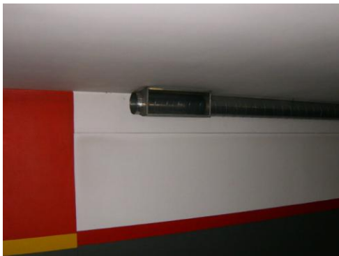
Figura 3.10 – Falta de grelhas nas condutas de ventilação
