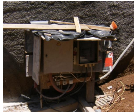
Figura 2.47 – Quadro provisório para fornecimento de energia eléctrica à obra
