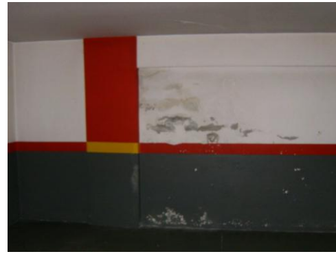
Figura 3.9 – Humidades nas paredes da garagem
