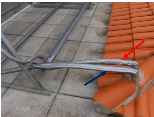
Figura 2.58 – Conduatas de circulação do fluído
