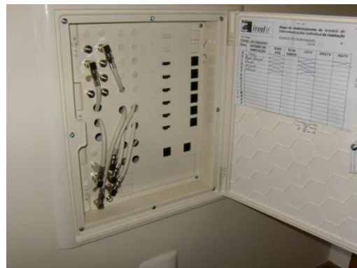
Figura 2.55 – Quadro de telecomunicações individual (aberto)
