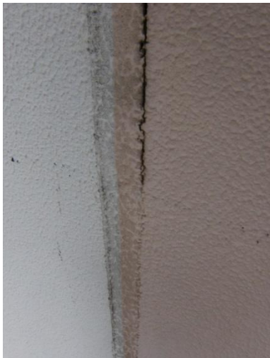
Figura 3.37 – Separação do mástique com o reboco
