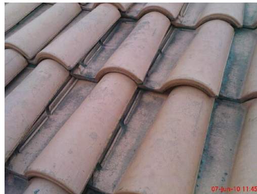
Figura 3.30 – Pormenor das telhas deslocadas
