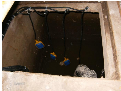
Figura 2.15 – Bóias de activação e alarme da central hidropneumática
