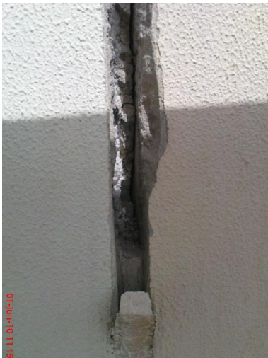
Figura 3.35 – Irregularidades na junta
