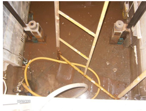
Figura 2.19 – Água no interior do poço
