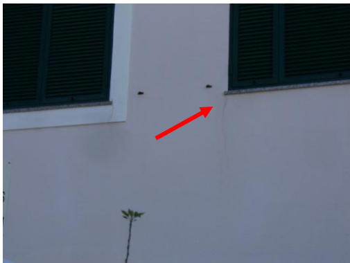
Figura 3.12 – Fissuração junto ao peitoril das janelas
