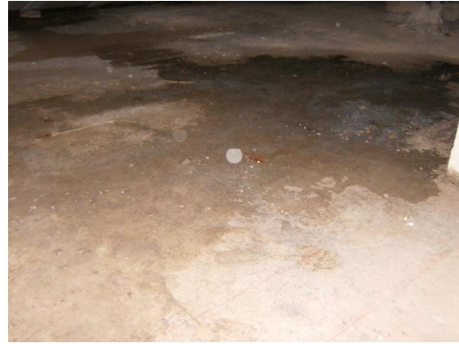
Figura 3.44 – Poça de água na laje
