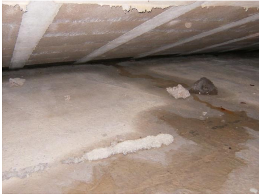
Figura 3.43 – Infiltração pelo beiral
