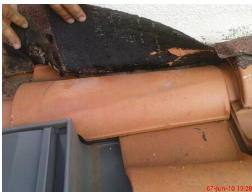
Figura 3.66 – Anomalia: má execução da impermeabilização
