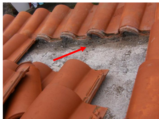
Figura 3.47 – Humidades na zona
