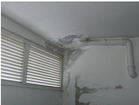
Figura 3.4 – Infiltração proveniente das tubagens
