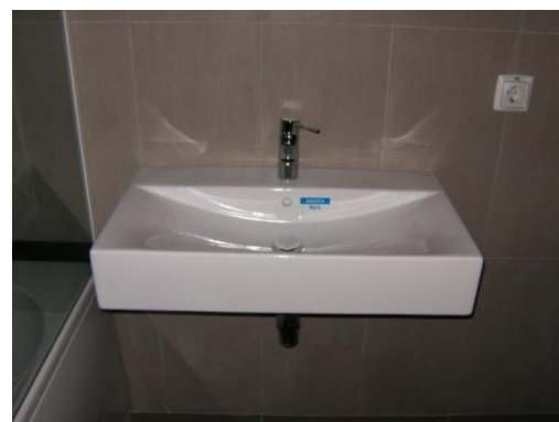
Figura 2.138 – Lavatório suspenso da i.s. privada
