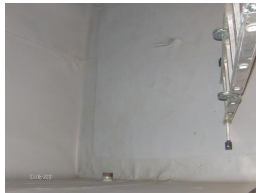
Figura 2.69 – Tanque de água potável
