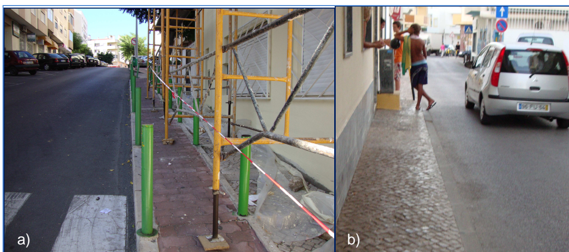
Figura 2.8 – Passeio estrangulado a) pela implantação provisória de andaimes; b) por caixas de electricidade
