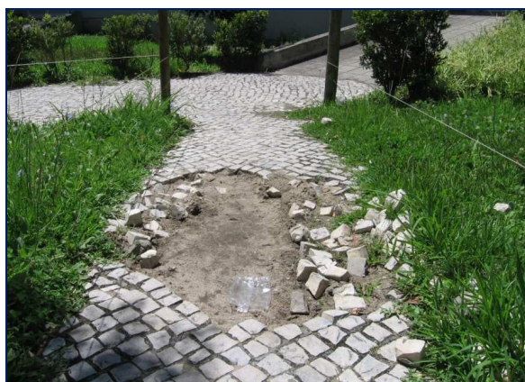
Figura 4.8 – Pavimento em mau estado (impedindo a passagem de uma cadeira de rodas)
