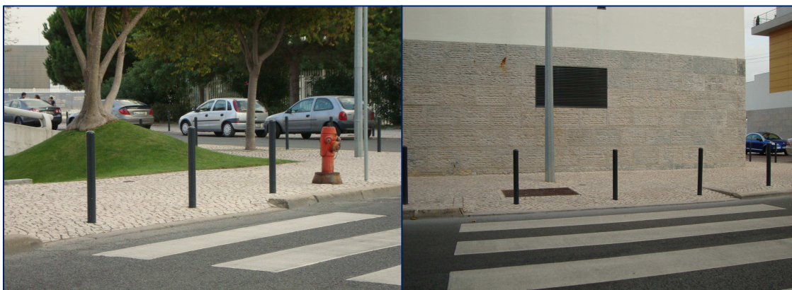
Figura 4.22 – Lancil de passeio na Rua da Musas mal executado, não apresentando o tipo de rebaixamento indicado no DL 163/2006
