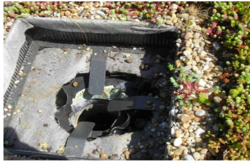
Figura 3.4 Rede de águas pluviais – Embocadura de “Tubo de queda.”, (Fonte: http://www.neoturf.pt , 2013)
