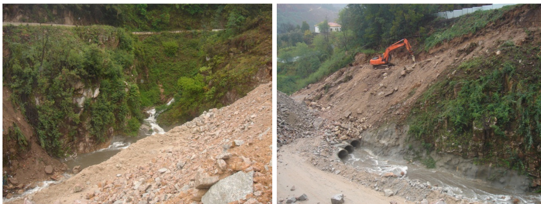
Figura 3.3 – Canal de Desvio do Rio Mau (Eng a . Ana Fortunato, 2012)
