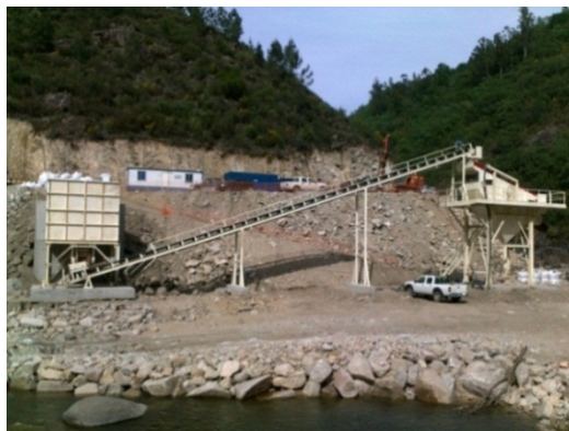
Figura 3.23 – Central de Lavagem e Crivagem de Agregado para BPCA, (Arquivo Pessoal).
