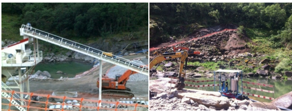
Figura 3.24 – Sistema de Alimentação da Central de Lavagem, (Arquivo Pessoal).
