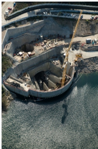
Figura 2.9 – Tomada de Água, (Construsalamonde A.C.E., 2012).
