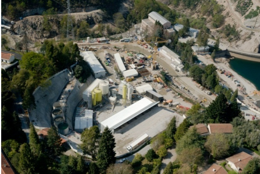
Figura 3.28 – Central de Betão, (Construsalamonde A.C.E, 2012).
