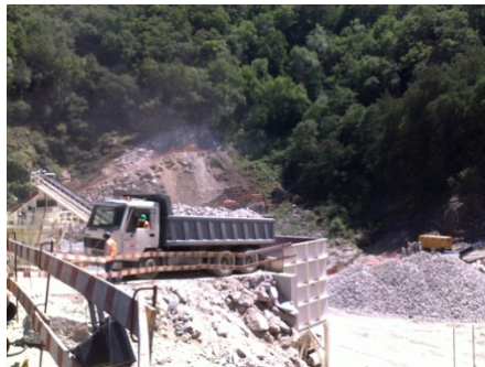
Figura 3.33 – Colocação do Agregado Grosso na Estrutura de Entrada da Central de Lavagem, (Arquivo Pessoa).
