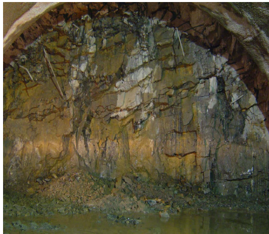
Figura 5 – Presença de água no interior do maciço.
