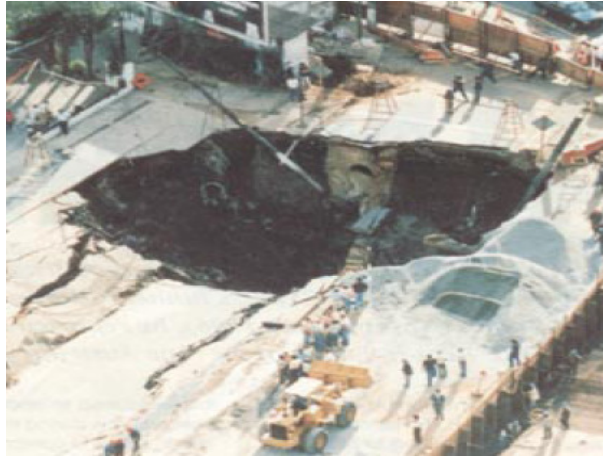
Figura 41 – Colapso do maciço terroso
