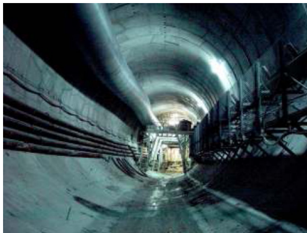
Figura 9 – Sistema de cabos e fios devidamente instalados [16].
