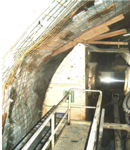
Figura 4 – Deformação na parede do túnel devido à pressão do maciço [adaptado de Seigre G.].
