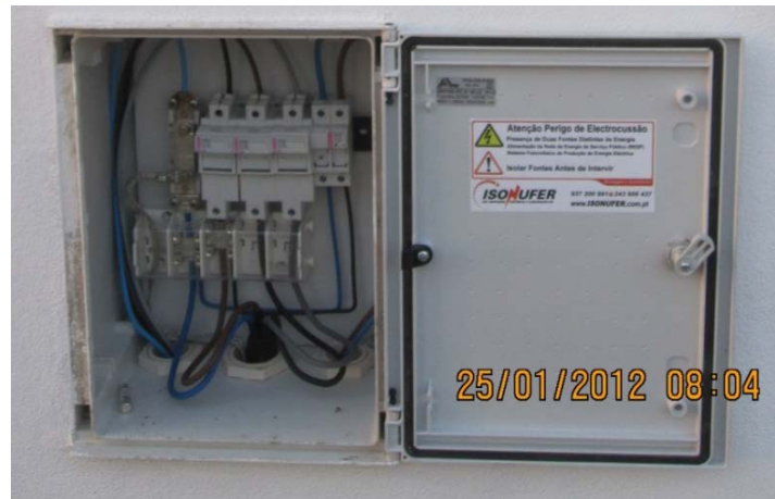
Figura 3.10 - Aviso de presença de duas fontes de tensão colocado em portinhola.
