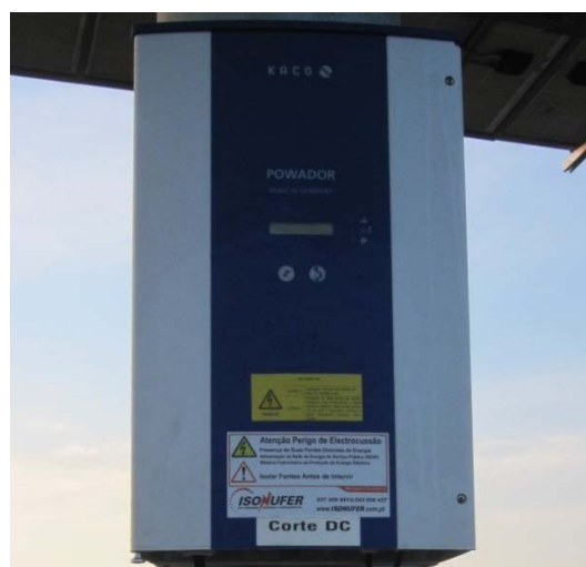
Figura 3.12 - Aviso modelo de operações de manobra colocado em inversor.
