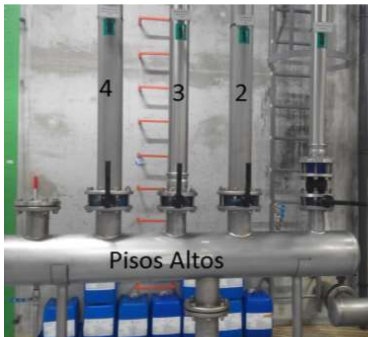
Figura 13 - Válvulas para distribuição de água para os pisos altos
