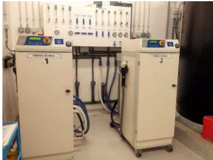
Figura 24 - Osmose inversa em série – hemodiálise
