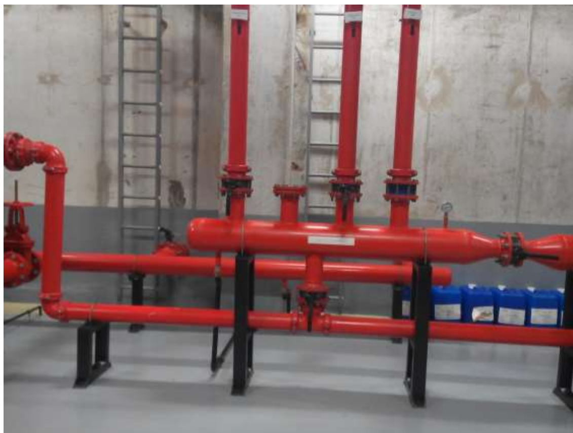
Figura 11 - Tubagem de incêndio na zona dos depósitos
