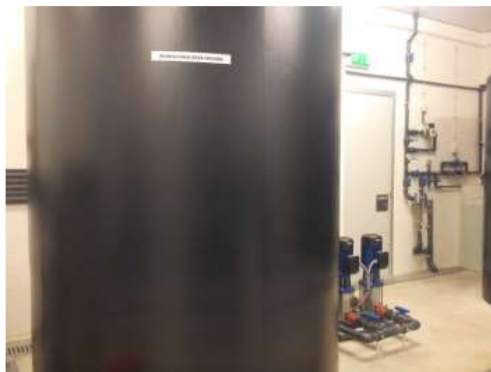
Figura 25 - Reservatório de água tratada – hemodiálise
