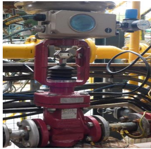
d) Válvula de controlo
