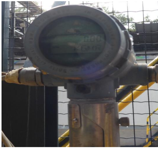
c) Caudalímetro de gás - venturi
