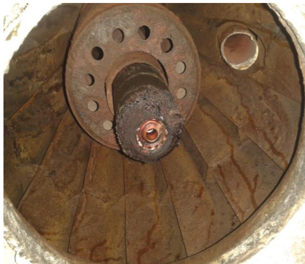
Figura 12 - Injetor principal de solventes no interior da câmara de oxidação
