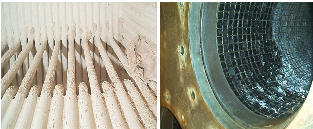
Figura 10 - Formação de sólidos de cloreto de amônia no interior da caldeira e interior dos filtros com a formação do sólido há superfície
