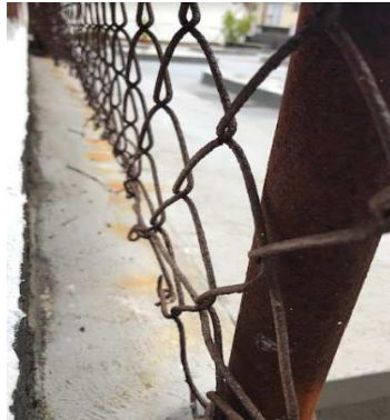
Figura 2.20 Vedação com sinais de corrosão.
