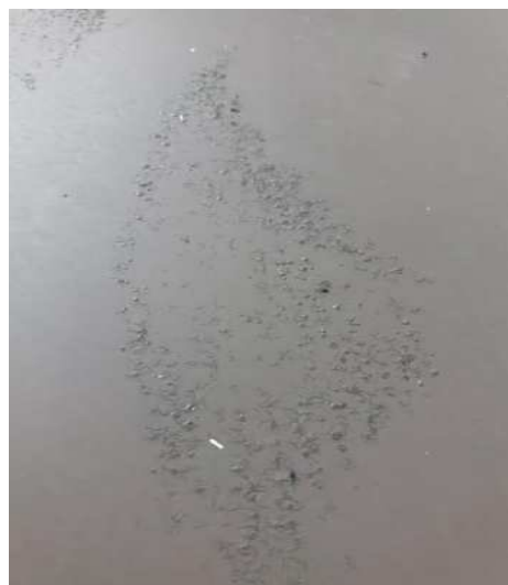
Figura 4.29 Detalhe do descasque do revestimento.
