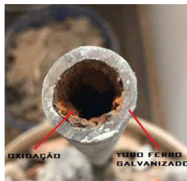
Figura 2.18 Corrosão no interior do tubo de água.
