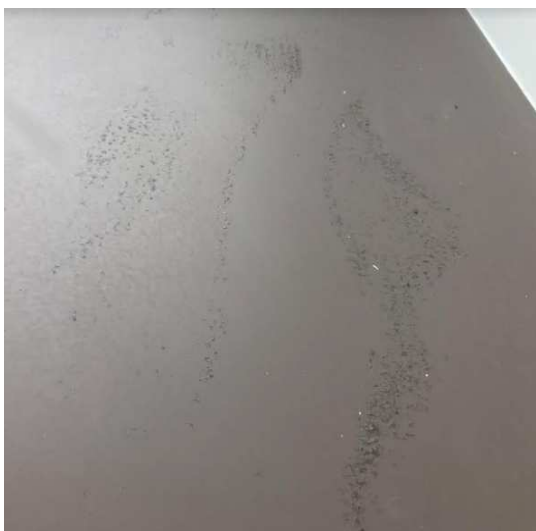
Figura 4.28 Descasque do revestimento.
