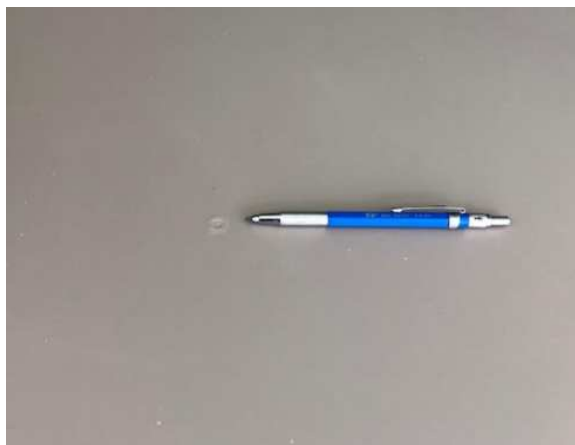
Figura 4.32 Reparação malsucedida no revestimento.
