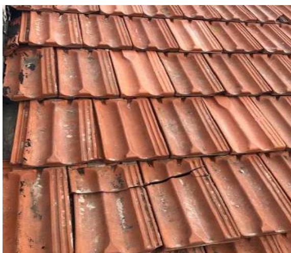
Figura 2.19 Estado do revestimento da cobertura.
