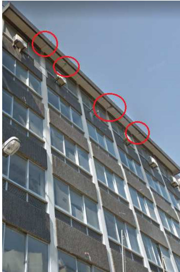
Figura 2.16 Patologias na pala do alçado principal.
