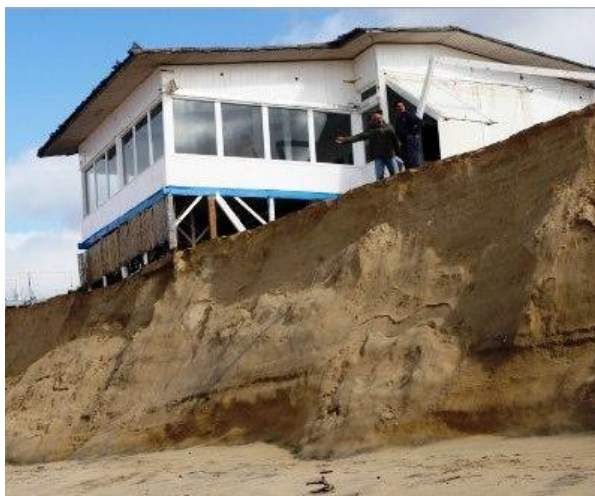
Figura 4.13. Danos dos processos erosivos devido à tempestade sentida em janeiro de 2008 [17]
