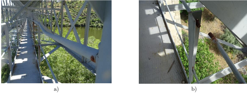
Figura 3.13 – Deformação e ruptura de elementos metálicos dos guarda corpos: a) Deformação e b) Ruptura.
