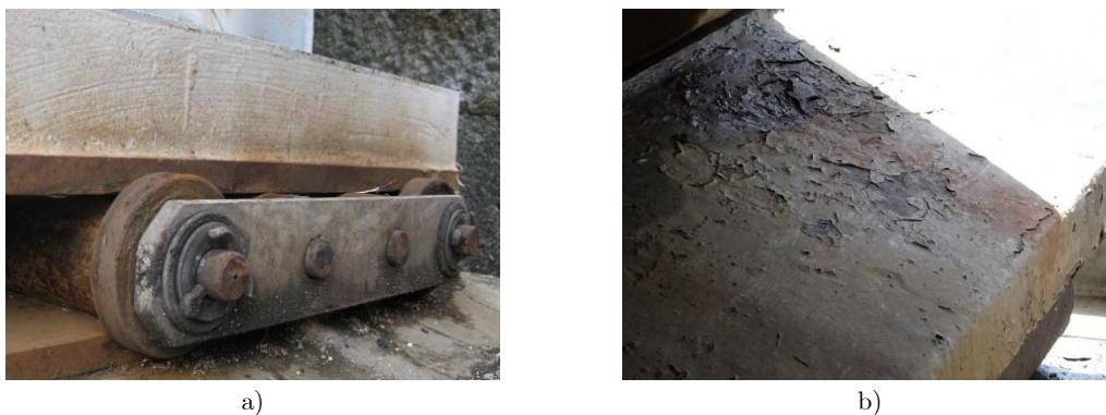
Figura 3.9 - Anomalias correntes em aparelhos de apoio: a) Falta de lubrificação em aparelhos de apoio; b) Delaminação da proteção de superfície.
