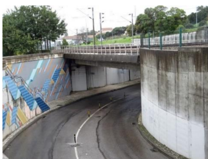
Figura 2.4 - Exemplo de uma ponte em viga contínua (pórtico): Linha de Sintra, Travessa de S. Domingos de Benfica.
