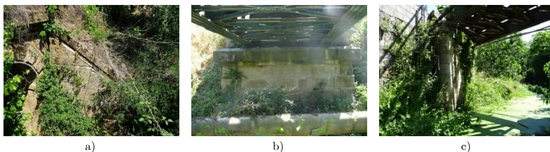
Figura 3.2 - Degradação por ataque de agentes biológicos: a) Muro de ala, b) Paramento frontal de um encontro e c) Envolvente de um encontro.
