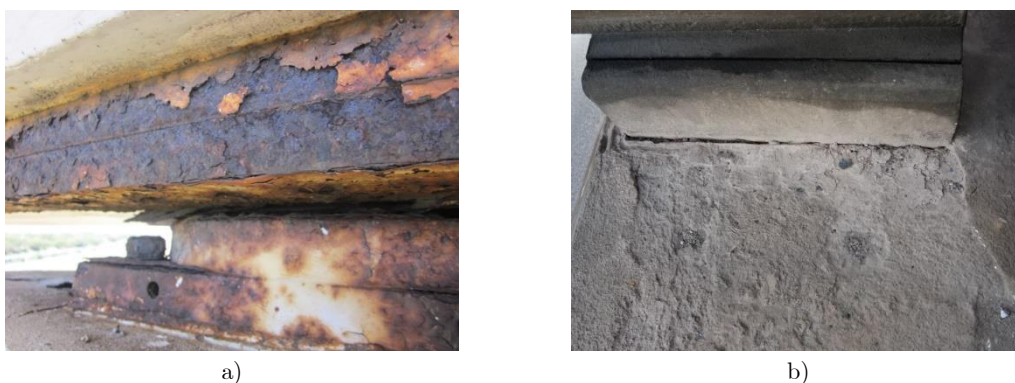
Figura 3.10 - Anomalias correntes em aparelhos de apoio: a) Corrosão de elementos metálicos e b) Existência de batimentos em aparelhos de apoio.
