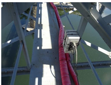
Figura 4.10 – Sistema de monitorização instalado na ponte ferroviária sobre o rio Tua.
