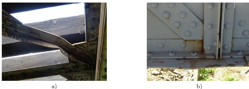
Figura 3.5 – Deformação local de elementos metálicos: a) No tabuleiro e b) Na estrutura de suporte.
