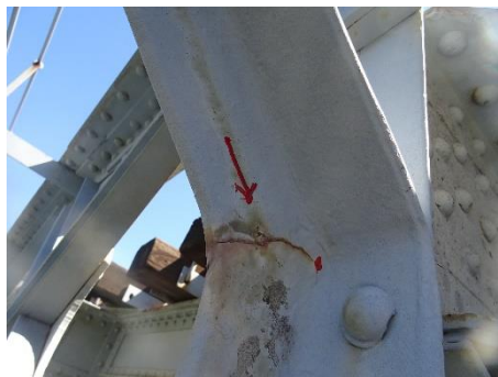
Figura 3.15 – Fissuração de elementos metálicos na estrutura de suporte do passeio.
