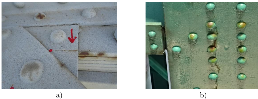
Figura 3.8 – Fissuração de elementos metálicos: a) Gousset de ligação e b) Face inferior do banzo da viga principal.
