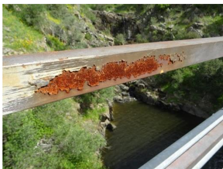
Figura 3.12 – Aparecimento de corrosão em elementos metálicos de guarda corpos e passeios.
