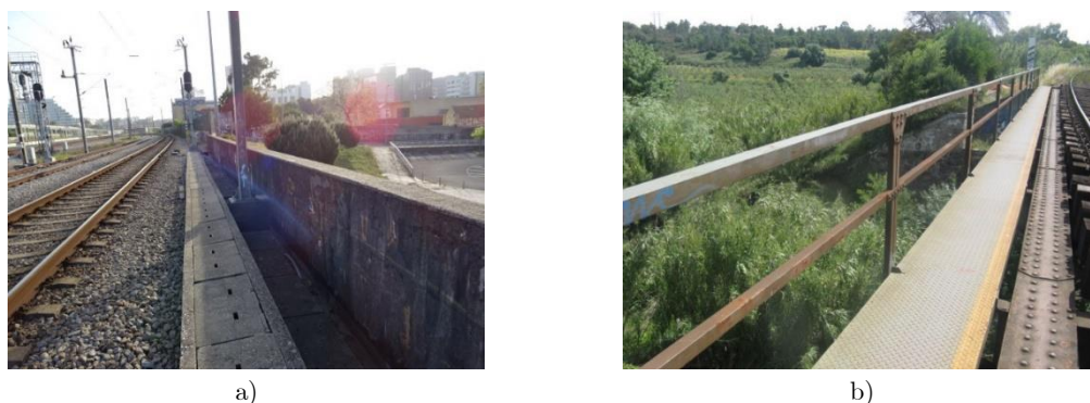
Figura 2.32 - Tipos de guarda corpos em pontes ferroviárias: a) Guarda corpos fabricados em obra e b) Guarda corpos metálico pré-fabricado.
