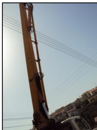
Fig.142 - Lança do camião bomba muito perto das linhas de alta tensão
