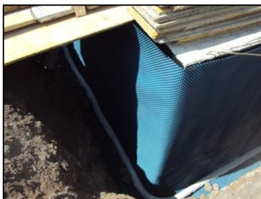
Fig.100 - Tubo dreno a circundar o muro da cave
