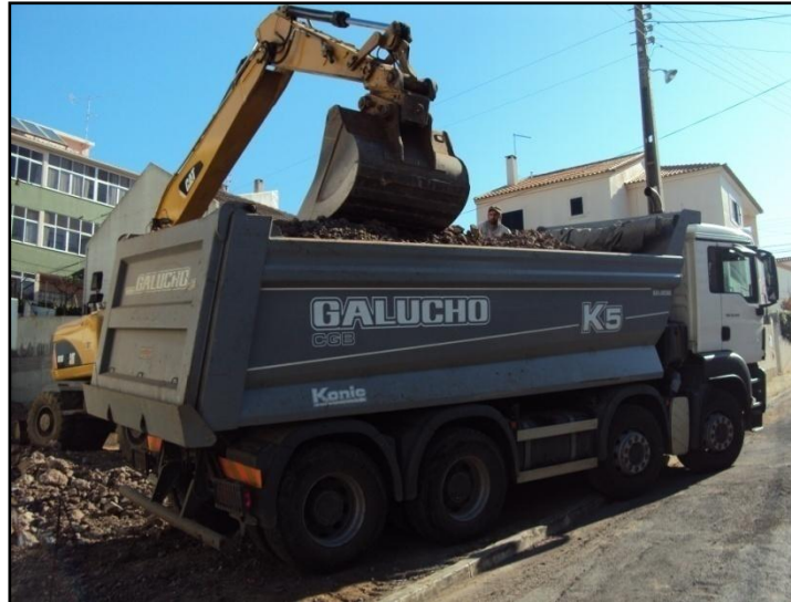
Fig.141 - Camião sem cobertura que impeça a queda de terras
