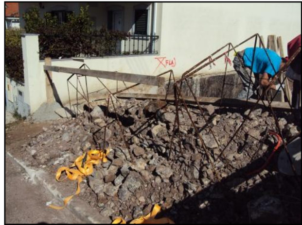
Fig.139 - Passeio da via pública obstruída
