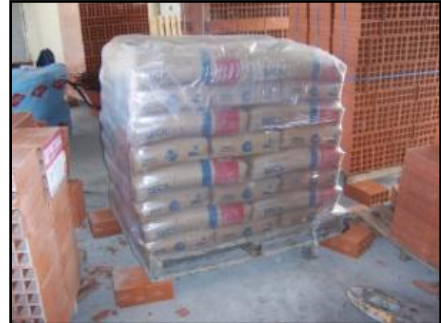
Fig.135 - Sacos de Cimento
