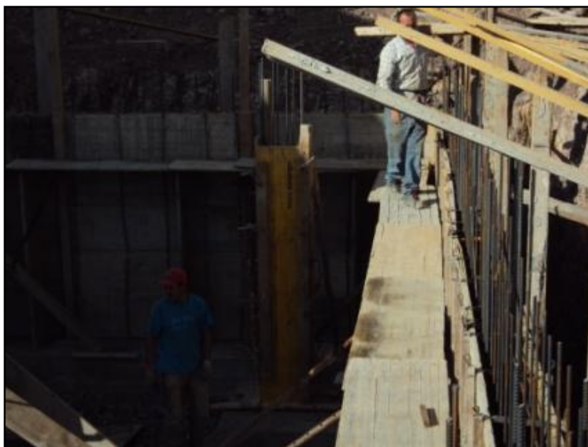
Fig.144 - Passadiço para efetuar a betonagem do muro da cave sem guarda-corpos
