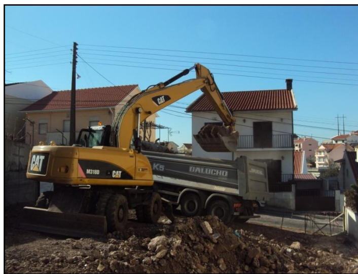
Fig.20 - Perigo de atingir os cabos elétricos de abastecimento público durante a escavação
