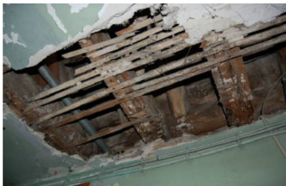
FIG. 2.7 – Estrutura de suporte do piso da cobertura em madeira: humidades e apodrecimento do material, com rotura do fasquiado e descasque do estuque. Corpo A, corredor do piso 2.
