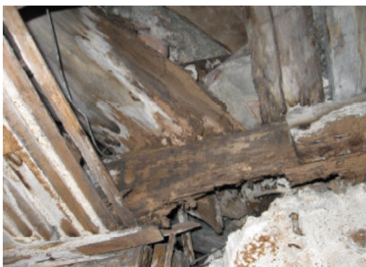
FIG. 2.8 – Estrutura de suporte da cobertura em madeira no Corpo A: elementos atacados por fungos da podridão.
