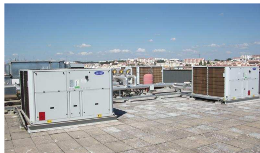
Figura 2: Chillers / Bombas de Calor
