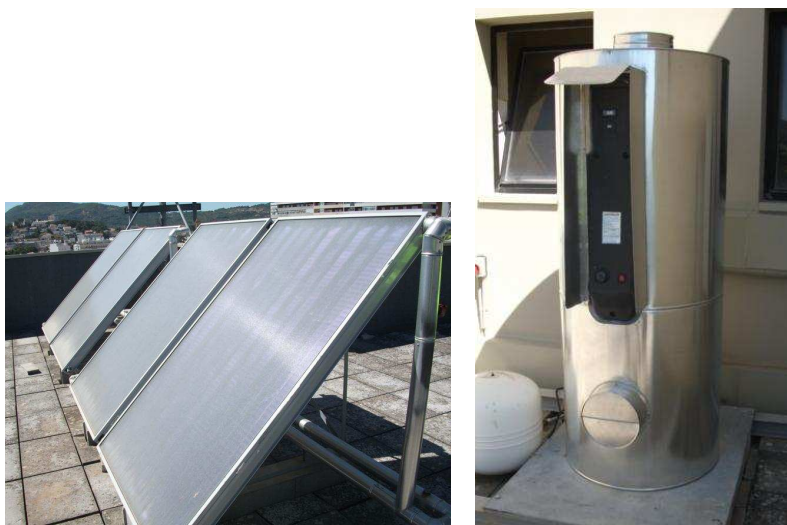
Figura 6: Sistema Solar Térmico
