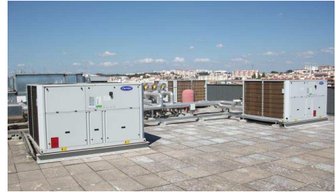
Figura 2: Chillers / Bombas de Calor
