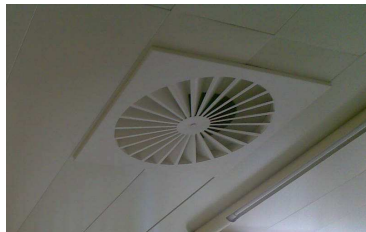
Figura 4: Difusor de insuflação de ar
