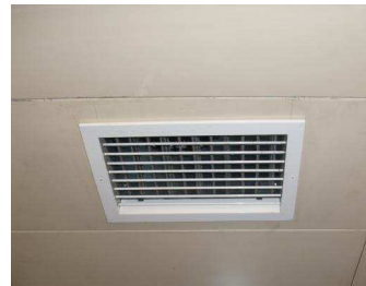
Figura 5: Grelha de extracção de ar
