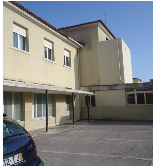
Figura 12 - Pormenor da fachada de tardo com relevância para os elementos de drenagem pluvial
