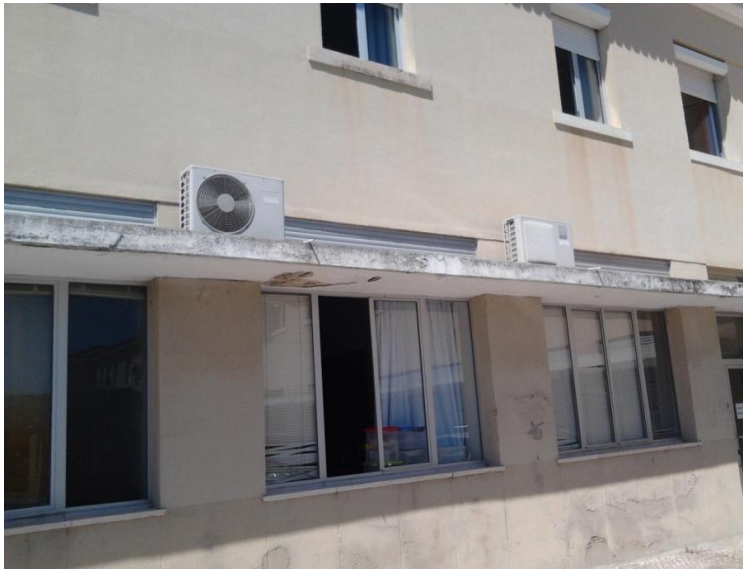
Figura 17 – Pala 2, escorrências na fachada provenientes das caixilharias e destacamento do revestimento de pintura na base da parede exterior
