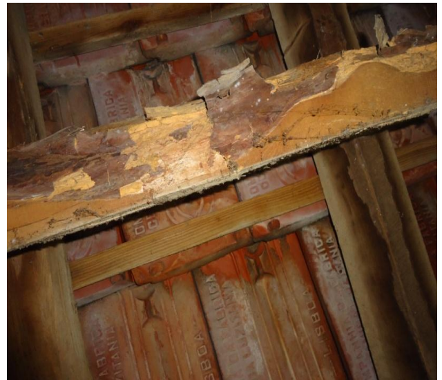
Figura 37 - Elemento de madeira deteriorado
