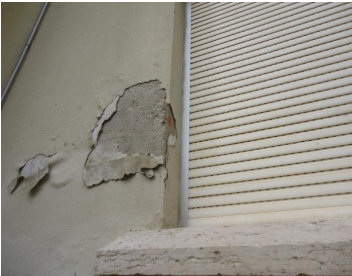
Figura 24 - Degradação acentuada do revestimento de pintura da fachada
