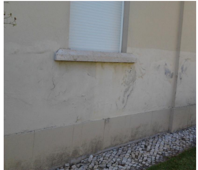
Figura 23 – Destacamento do revestimento de pintura na fachada
