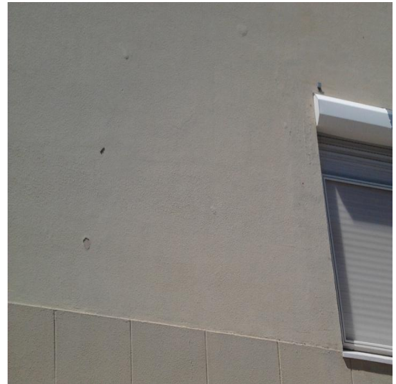
Figura 15 – Bolhas no revestimento de pintura na fachada
