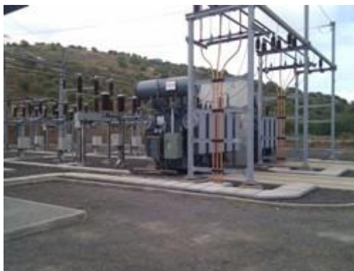
Figura 3 - Subestação no Palmarejo de 50 MVA. Fonte: www.governo.cv
