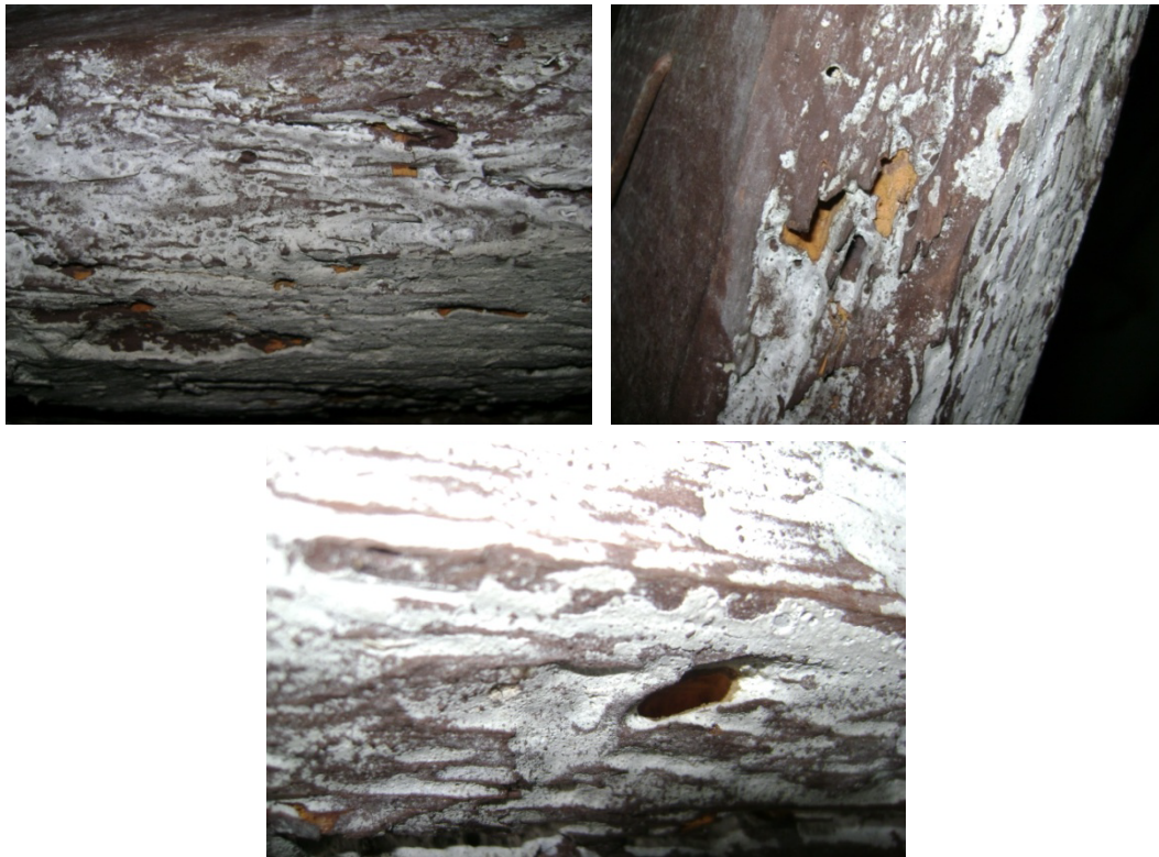
Figura 5.27: Aspecto de degradação do Elemento 2 da cobertura dos arrumos (Canto inferior) e orifício de saída do caruncho grande
