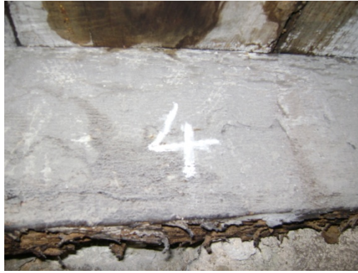
Figura 7.11: Degradação biológica por térmitas (elemento 4 da cobertura dos arrumos)
