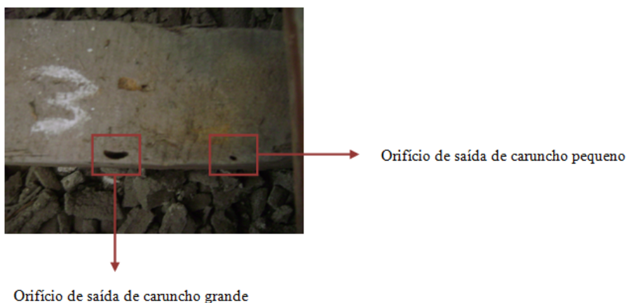
Figura 5.9: Presença de orifícios de saída do caruncho na Viga 3 do pavimento
