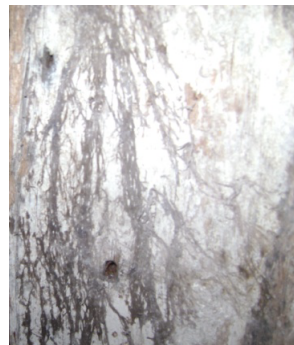
Figura 2.33: Presença de hifas em peça de madeira (Edifício localizado na Calçada do Sacramento, Baixa de Lisboa)
