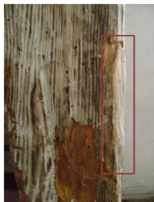
Figura 7.9: Descaio em elementos da cobertura do lanternim: pendural (1)
