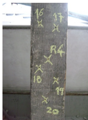
Figura 5.38: Localização dos ensaios realizados no Elemento 4 da cobertura do lanternim (Face orientada para Sudeste)
