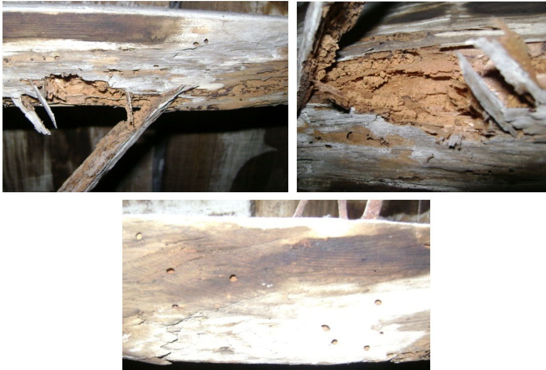
Figura 5.24: Aspecto de degradação do Elemento 1 da cobertura dos arrumos (Canto inferior) e orifícios de saída do caruncho pequeno e grande
