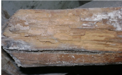
Figura 2.37: Podridão castanha (Edifício localizado na Calçada do Sacramento, Baixa de Lisboa)
