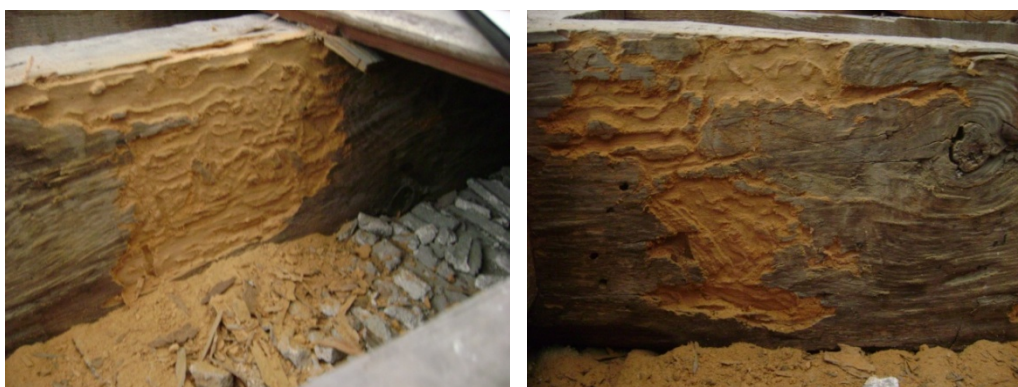
Figura 5.12: Empolamento da superfície da Viga 8 do pavimento (Face orientada para Noroeste)
