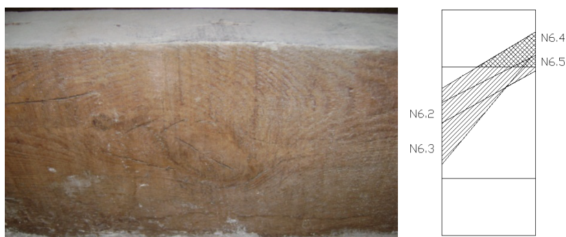
Figura 7.6: Avaliação da posição da medula da viga 6 do pavimento (imagem representativa e secção transversal)
