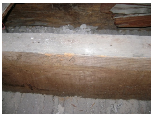
Figura 5.18: Aspecto de degradação da Viga 10 do pavimento (Face orientada para Sudeste)
