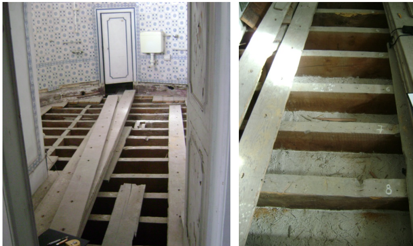
Figura 4.5: Vista geral do pavimento (entrada da instalação sanitária) e disposição das vigas
