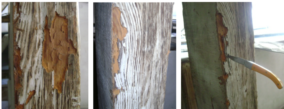
Figura 5.34: Aspecto de degradação do Elemento 1 da cobertura do lanternim (Face orientada Sudeste e Nordeste)
