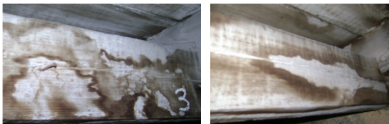
Figura 5.28: Sinais de humedificação anterior no Elemento 3 da cobertura dos arrumos
