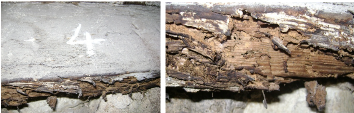
Figura 5.31: Aspecto e pormenor de degradação do Elemento 4 da cobertura dos arrumos (Canto inferior)
