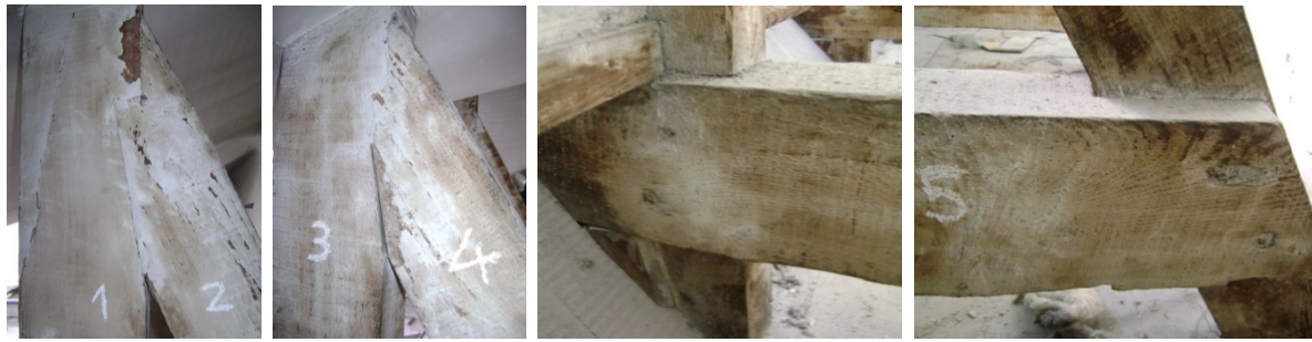
Figura 4.11: Ligação do tipo respiga e mecha entre os pendurais e diagonais e Ligação de encaixe entre nível-pendural e nível-diagonal
