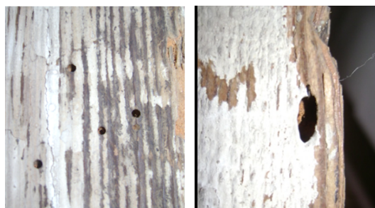
Figura 5.35: Orifícios de saída do caruncho grande no Elemento 1 da cobertura do lanternim
