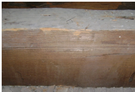
Figura 5.17: Aspecto de degradação da Viga 9 do pavimento (Face orientada para Noroeste)
