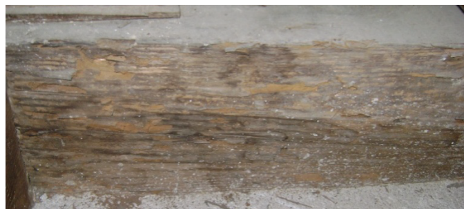
Figura 7.4: Degradação superficial (viga 13 do pavimento)
