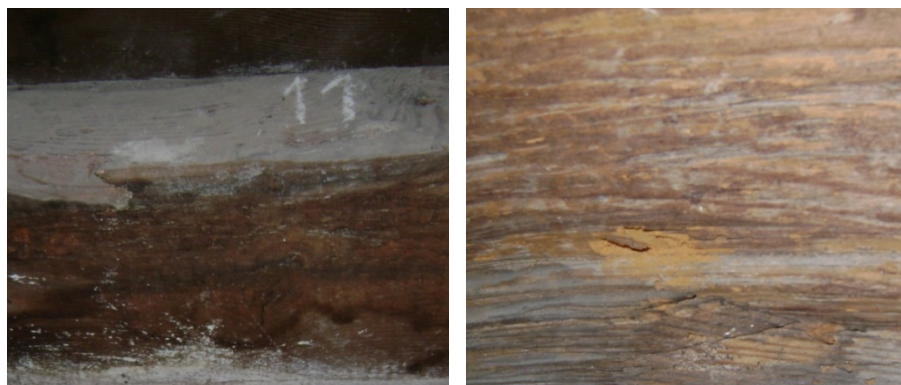
Figura 5.19: Aspecto de degradação e empolamento da superfície da Viga 11 do pavimento (Face orientada para Noroeste)
