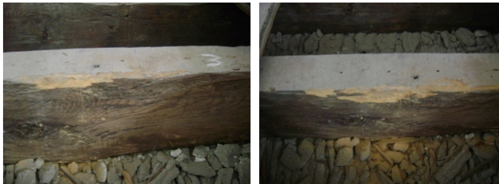
Figura 5.8: Aspecto de degradação da Viga 3 do pavimento (Face orientada para Noroeste)
