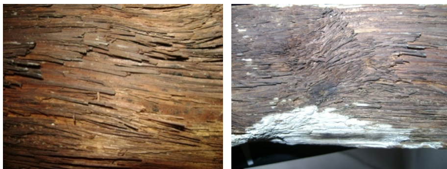
Figura 5.41: Pormenor de degradação do Elemento 5 da cobertura do lanternim (Canto inferior)
