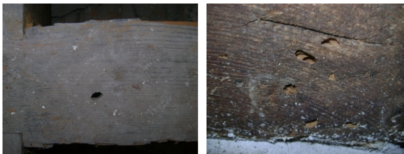
Figura 5.13: Orifícios de saída do caruncho pequeno e grande na Viga 8 do pavimento
