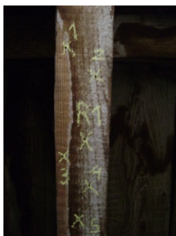
Figura 5.29: Localização dos ensaios realizados no Elemento 3 da cobertura dos arrumos (Canto inferior)
