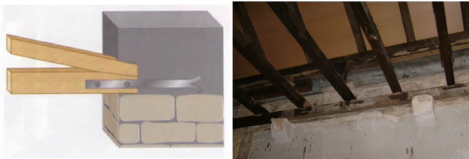
Figura 2.17: Entrega de asna: representação esquemática com recurso a elementos metálicos (Appleton, 2011) e imagem real com recurso a mísula, elementos de alvenaria de pedra (Edifício localizado na Calçada do Sacramento, Baixa de Lisboa)
